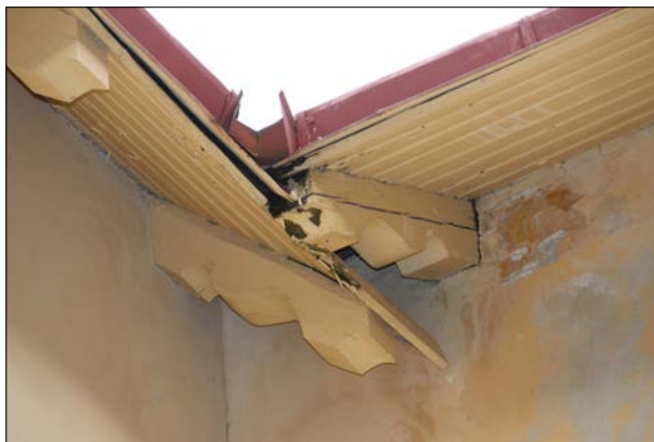
Skador i takutsprång och på fasad, byggnadshörn mot sydväst.
