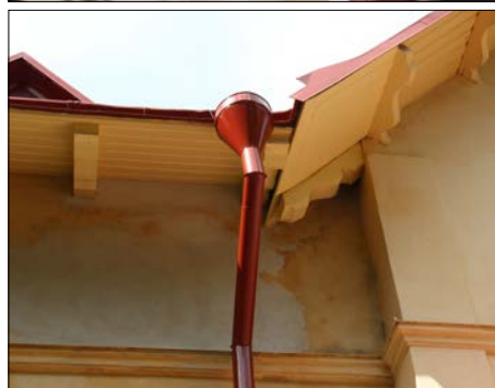
Foton visar exempel på takavvatning före och efter entreprenad. I bild syns även putsckador samt utförd putslagning.
