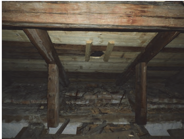
Figur 32. Hålen i undertaket har delvis återskapats. Foto: Helén Sjökvist.
