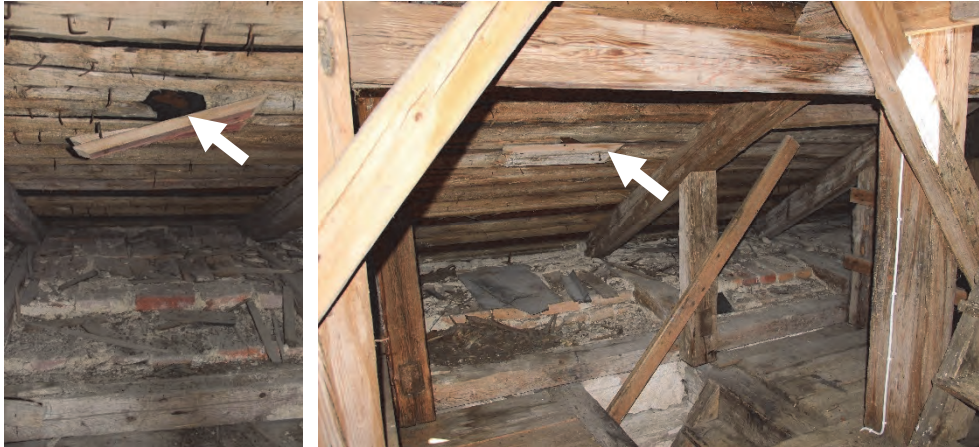
Figur 29. I underbrädningen för torrtaket finns på jämna avstånd hål med okänd funktion, vilka ibland satts för provisoriskt, se pil. Foto: Helén Sjökvist.
