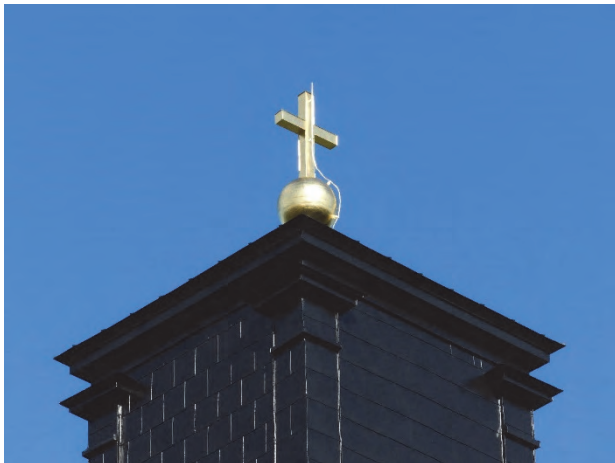
Figur 22. Ommålad plåt på lanterninens väggar samt ny hänggränna och omförgyllt kors. Foto: Helén Sjökvist.
