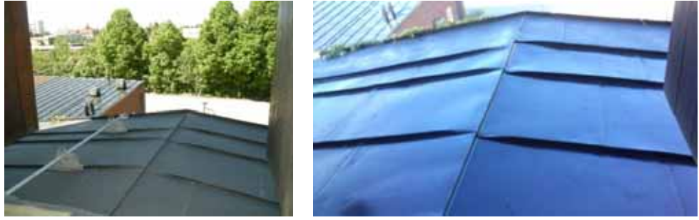
Figur 213. Tak vid ljudluckor mot väster före åtgärder. Foto: Helén Sjökvist.
