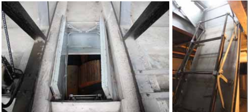
Figur 217 och 218. Taklucka före åtgärder. Foto: Helén Sjökvist.
