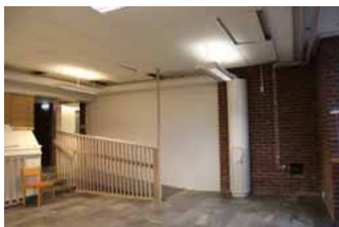
Figur 145. KM13026_0328 Duvan 024. Igengipsat glasparti och nya ventilationsinstallationer i tak och på vägg.
