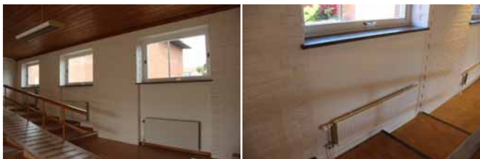
Figur 119. KM13026 Tomaskyrkan_0921 Musiksal 166 före åtgärd, radiatorer placerade i nischer.
