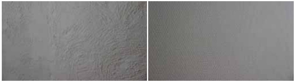
Figur 85. KM13026 Tomaskyrkan_0812 Kalkputsad och kvastad yta på vägg mot väster i kontorsrum som ska bli västra delen av café.
