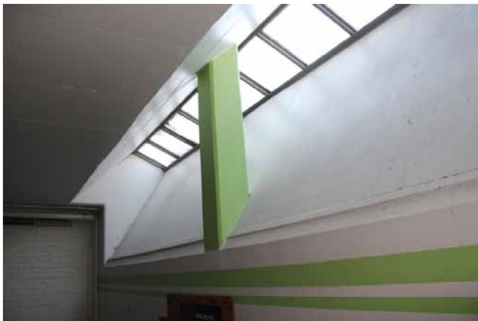
Figur 223. Ljusinsläpp före åtgärder. Foto: Lisa Skanser.
