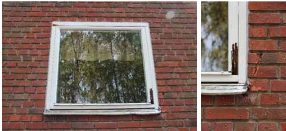
Figur 207. Exempel på rötskador på fönster. Foto: Tobias Mårud.
