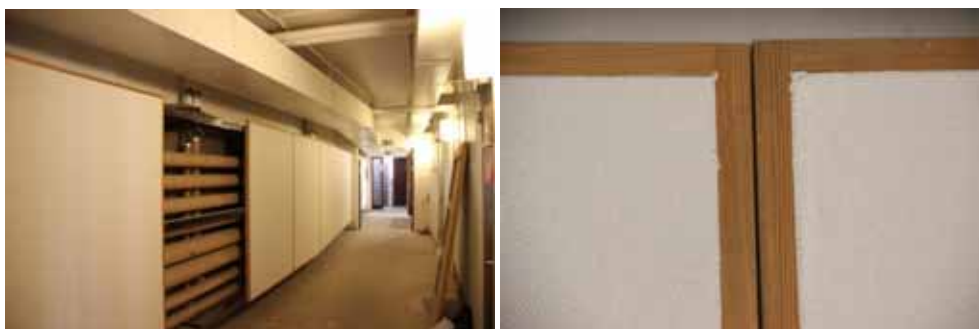
Figur 46. KM13026 Tomaskyrkan_1084 Korridor utanför vävlokal och träslöjd. Ventilationsrör är dolda bakom väggskärmar som återmonterades.
