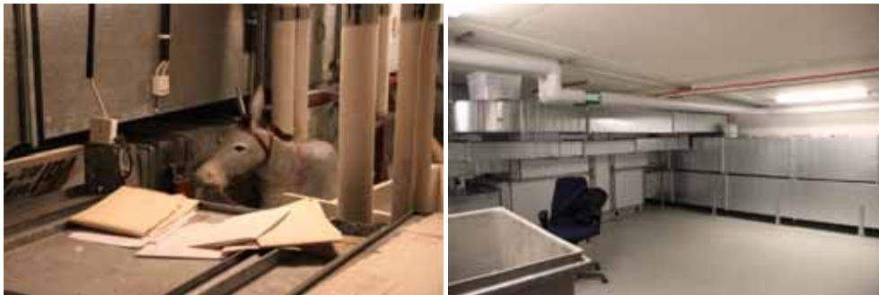
Figur 148. KM13026 Tomaskyrkan_1260 Del av fläktrum 030 före åtgärd.
