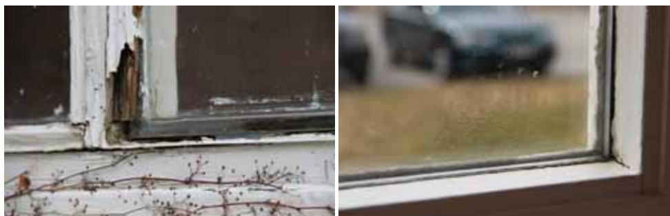
Figur 8. KM13026_0014. Trälister kring glasrutor var rötskadade.
