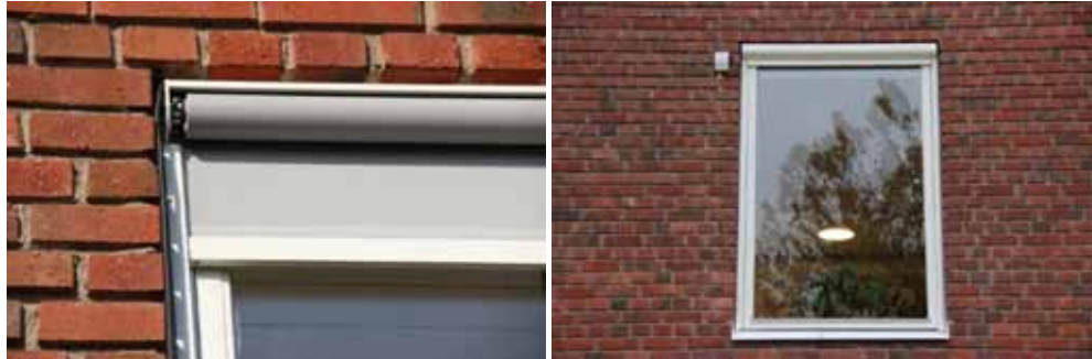
Figur 16. KM13026_0131 Detalj av monterad solskyddsgardin på övre våningens fönsterkarm. Fönstren ligger något indragna vilket möjliggjorde att gardinen hamnade i liv med fasaden i överkant. Figur 17. KM13026_0220 Fönster i södra fasaden efter att solskyddsgardiner och tillhörande apparatur monterats.
