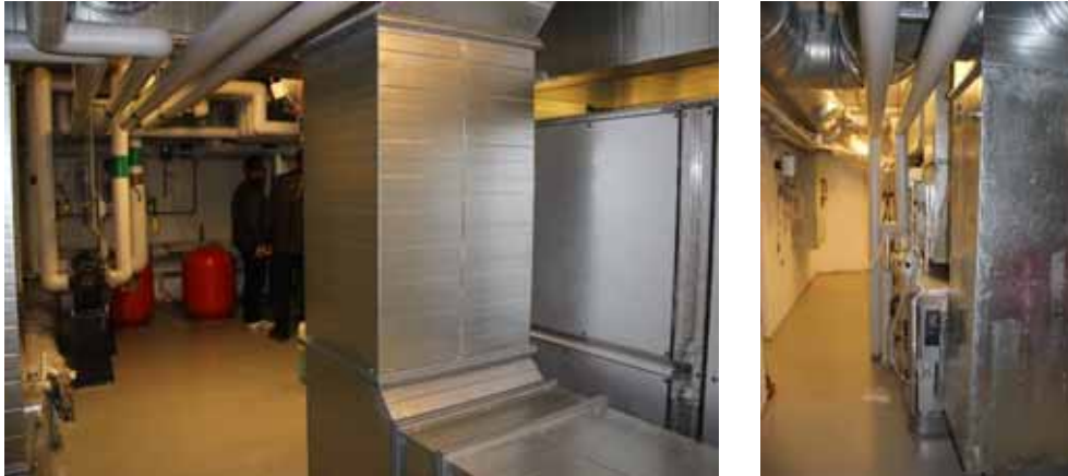
Figur 235 och 236. Fläktrum/UC efter åtgärder. Foto: Helén Sjökvist.
