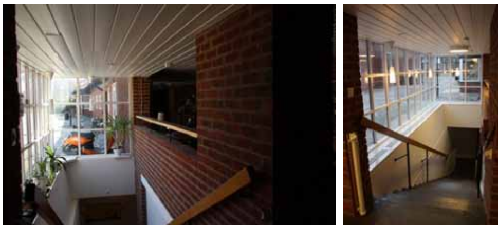
Figur 154. KM13026 Tomaskyrkan_0620 Trappa 15 före åtgärd.
