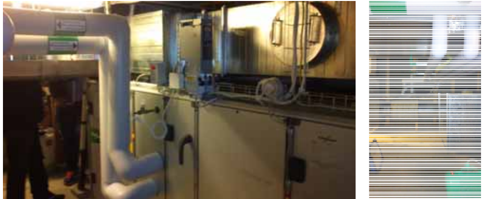
Figur 215 och 216. Fläktrum med ny utrustning efter åtgärder. Foto: Helén Sjökvist.
