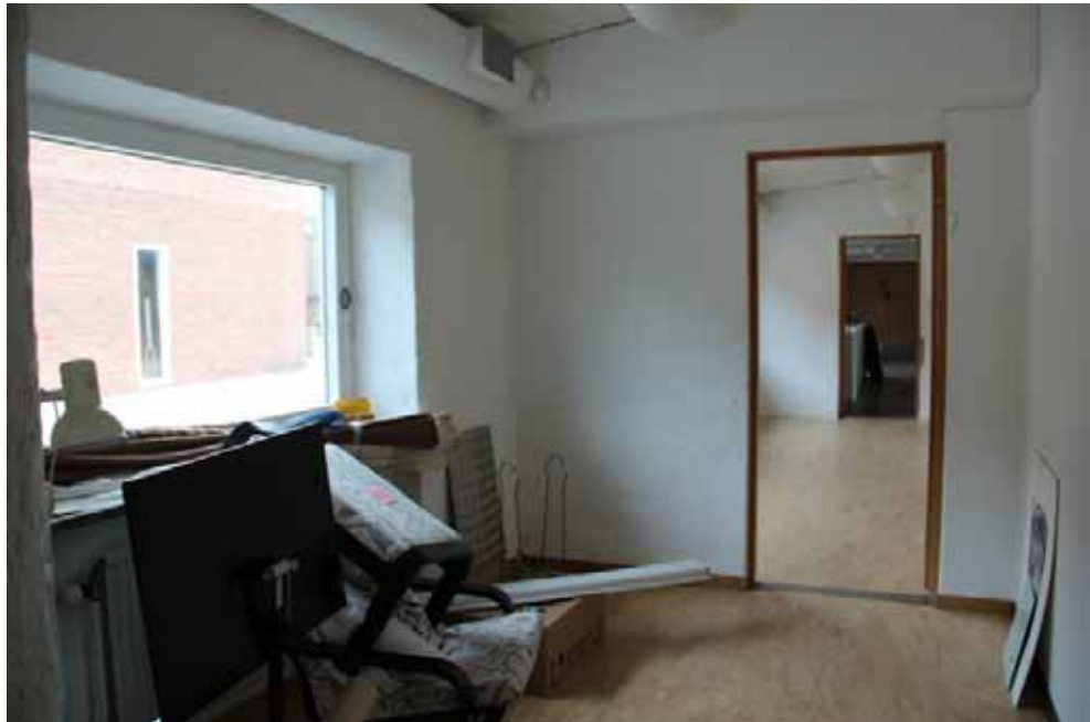
Figur 74. KM13026 Tomaskyrkan_0762 Passage 155 innan åtgärd. En vitmålad ventilationstrumma var monterad under taket över fönstret och på kortväggen mot öster fanns en inklädd ventilationskanal.
