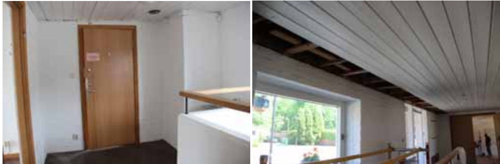
Figur 94. KM13026 Tomaskyrkan_0834 Hall 158 dörröppning och ventilationskanal i nordvästra hörnet innan åtgärd.
