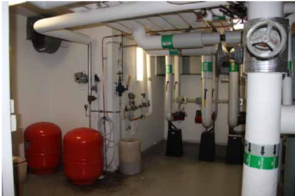
Figur 234. Teknikrum före åtgärder. Foto: Lisa Skanser.
