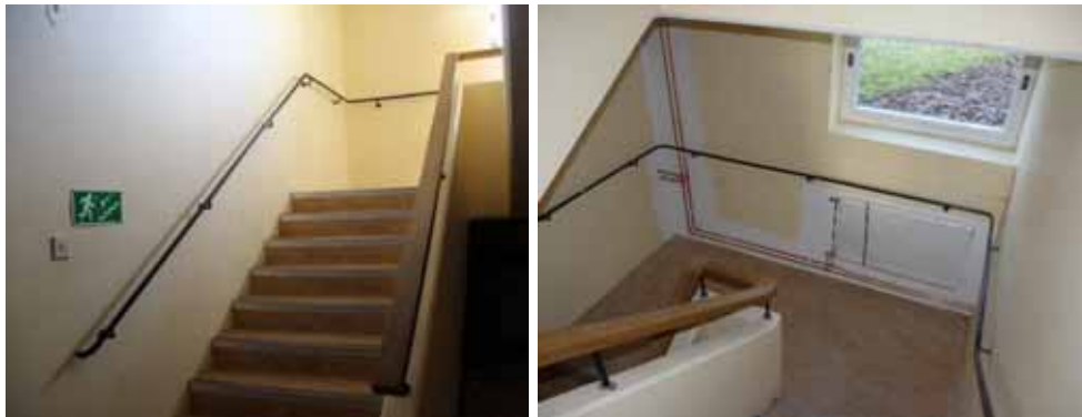
Figur 246. Trapplopp före åtgärder. Foto: Helén Sjökvist.
