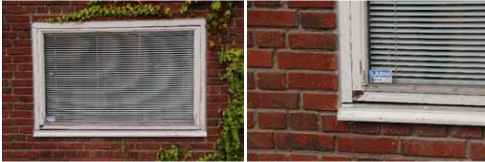
Figur 209. Exempel på rötskador på fönster. Foto: Tobias Mårud.
