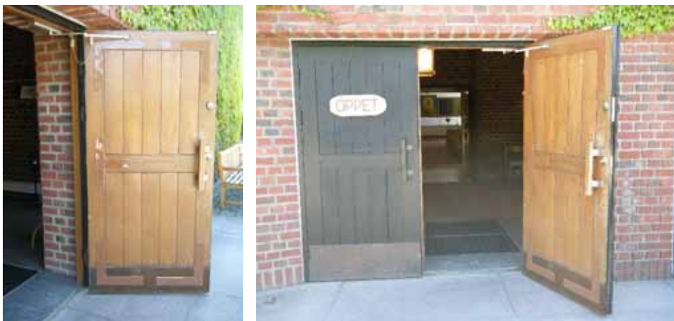
Figur 201. Dörrbladet har tidigare fått förstärkas, i nedre delen har man skruvat hörnjärnen direkt i sparkplåten. Foto: Helén Sjökvist.
