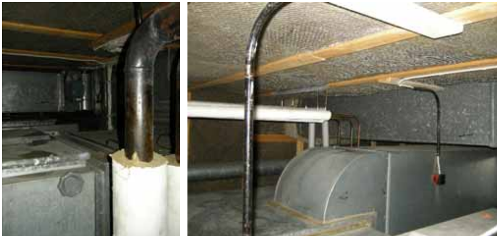
Figur 211 och 212. Befintlig fläktutrustning före åtgärder. Foto: Helén Sjökvist.
