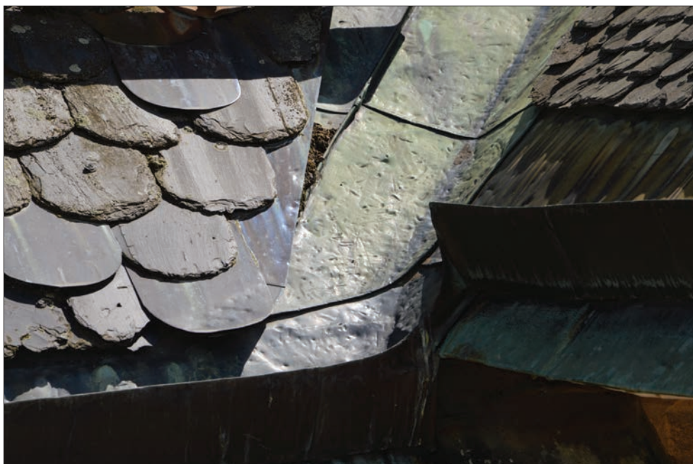
Figur 13. Foto 050. Skador i ränndals- och fotplåten. Ilagningar med kopparplåt samt skruv genom skiffret syns till vänster i bild.
