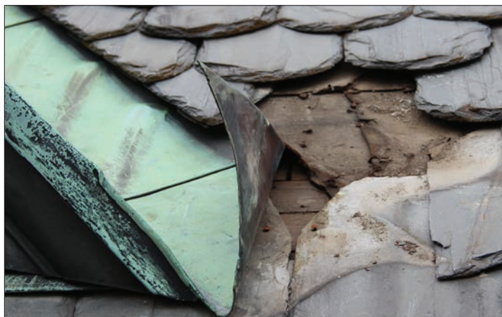
Figur 23. Foto 290. Lumpapp synlig under skiffret. Pappen slutade intill takkuporna som inte hade någon papp.
