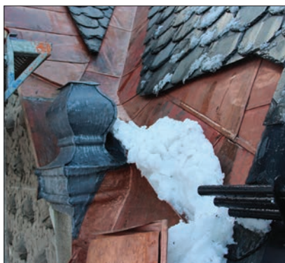
Figur 43. Foto 193. Dekorationen åt väster efter åtgärd. Snö och vatten leds åt sidan.
