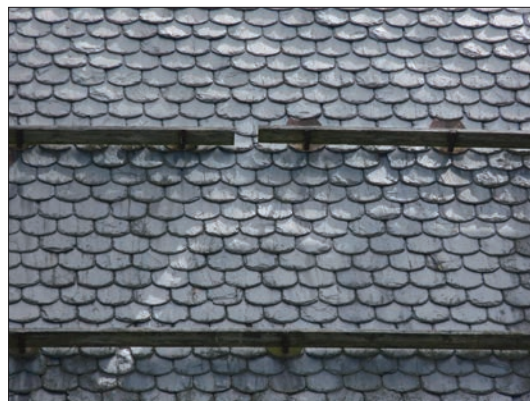
Figur 36. Foto 007. Snörasskydd av plank.
