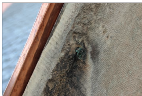
Figur 30. Foto 172. Tidigare infästning av kopparplåt mot sten synlig, gavel på byggnadsdel mot torget.
