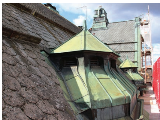
Figur 26. Foto 257. Takfall utmed Bergsmansgatan innan omläggning.
