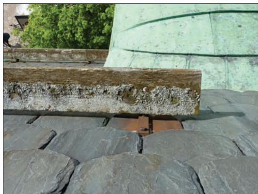
Figur 35. Foto 041. Snörasskydd av plank.
