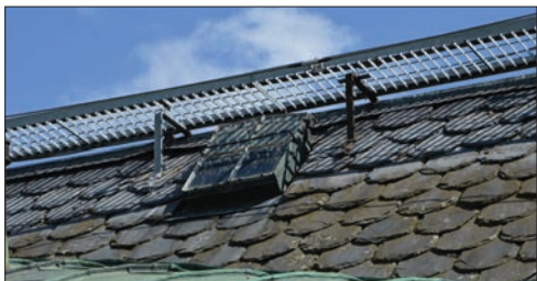
Figur 39. Foto 049. Takfönster före renovering.
