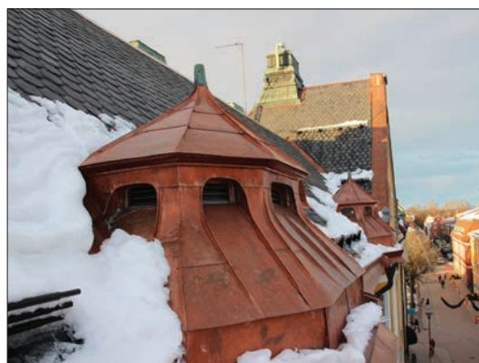
Figur 27. Foto 379. Takfall utmed Bergsmansgatan efter omläggning.
