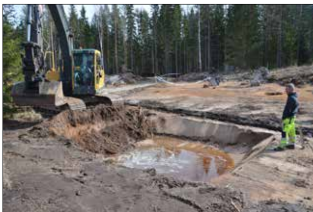
Figur 84. Pågående utgrävning av damm för vattensäll inom delområde 1. Foto från sydväst av Josefina Kennebjörk.
