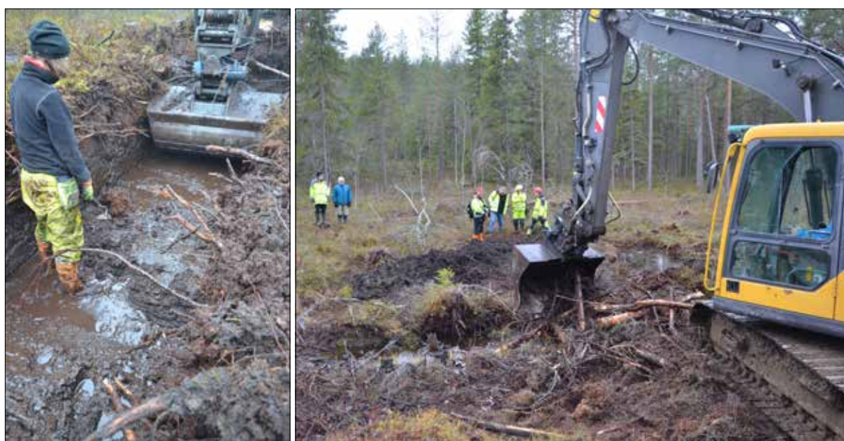
Figur 132–133. Nora 430. Inledande schaktning i delområde 4, mossmarken (t.v.). Schaktning i delområde 4, mossmarken. Referensgruppsmöte i jält (t.h.). Foto från öster av Mattias Johansson.
