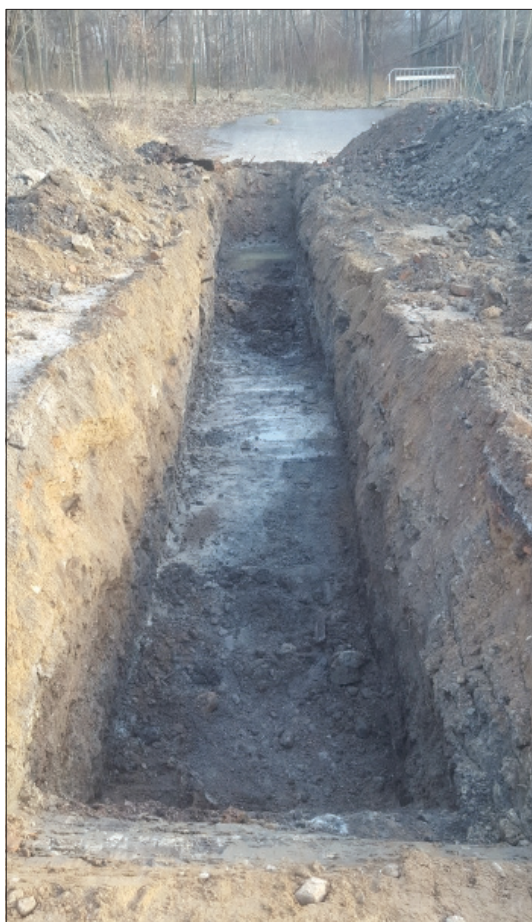
Figur 7. Schakt 3 från söder. I botten av schaktet syns lera samt partier av sand med rikligt med småsten. Även rester av bottenfällningen till än skymtar i botten av schaktet. Foto Josefine Kennebjörk.
