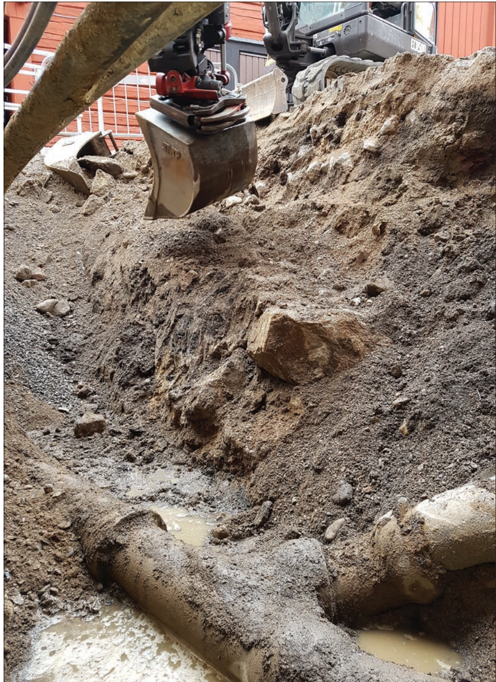
Figur 9. Grävmaskinen rensar upp lösa massor i schaktet. Äldre VA-rör närmast i bild. A2, stenlagd yta, kan ses i schaktväggen (sektion 1a) höger om grävskopan och under skopan är delar av sektion 1b frammensade. Foto från öster av Oskar Spjuth.
