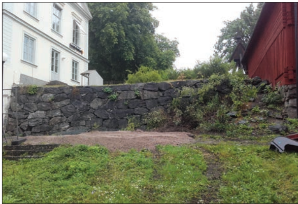
Figur 37. Muren, A3, sträckte sig mellan Stiftskansliet och Biskopens stallar. Muren har utgjort grundläggning till den sydvästra väggen i hus 4. Foto från sydväst.
