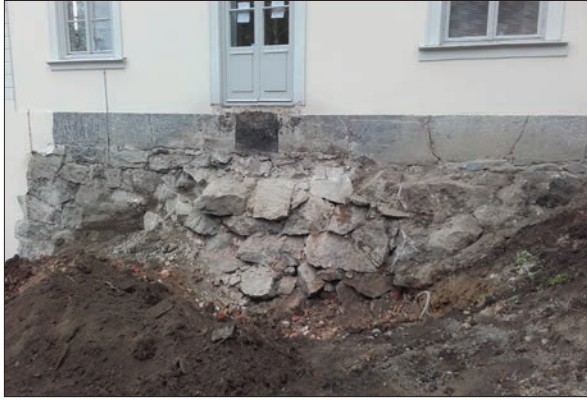
Figur 36. Stiftskansliet uppfördes på 1800-talet. Inmurat i grunden till Stiftskansliet fanns stenar som har varit grundstenar i hus 4:s nordvästra vägg. Foto från sydöst.
