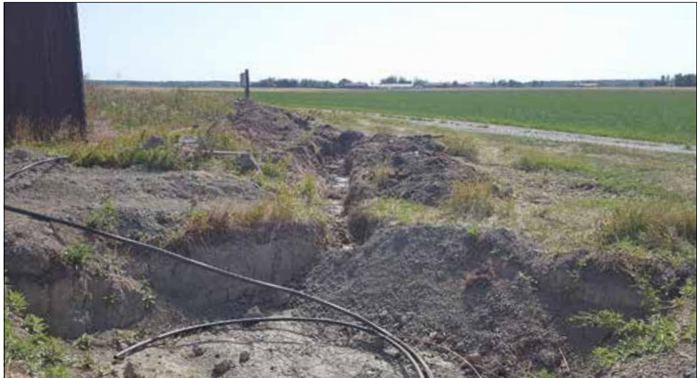
Figur 9. Schakt grävt invid befintlig kabel. I förgrunden schaktet för ny transformatorstation. Foto från nordväst.
