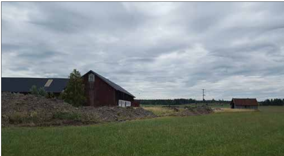
Figur 6. Arbetsbild över del av schakt som grävts för ny markkabel, väster om ladugård. Foto från norr.
