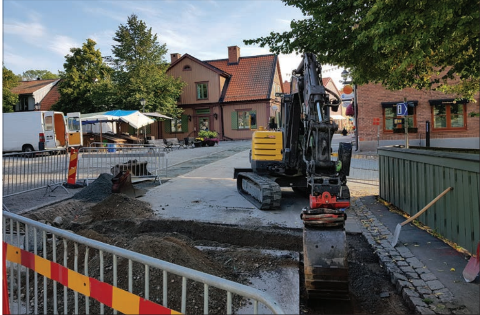
Figur 5. Sydvästra delen av schaktet gick över Stora Gatan till en befintlig brunn vid kvarteret Draken. Foto från väster av Jonas Ros.
