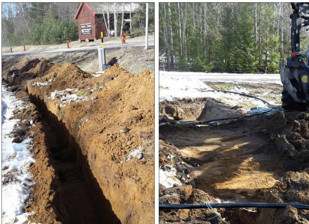
Figur 7 (t.v.). Kabelschaktet i den del det berör boplatsen vid Dammstugan. Foto från ÖSÖ av Britta Kiblstedt. Figur 8 (t.h.). Den större yta som togs upp inom boplatsytan i kabelschaktets östligaste del. Foto från väster av Britta Kiblstedt.
