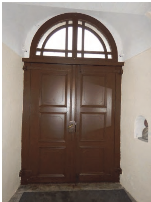
Figur 4. Entrén före åtgärder. Foto Svensk Klimatstyrning.
