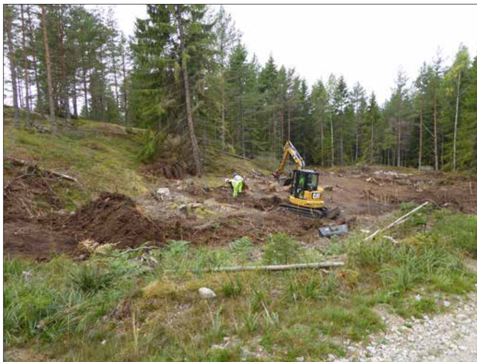
Figur 50. Helgona 432 fotad från vägen i öster under pågående schaktning. Foto Tom Carlsson.
