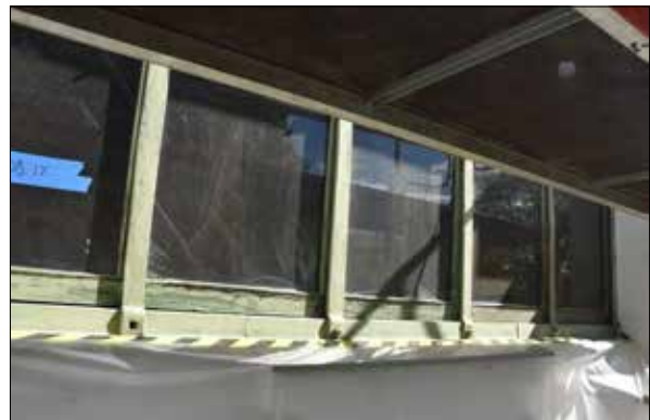
Figur 11. Fönster över västra entrén, utvändigt med beslag av smidesjärn. Även vissa fönsterglas var trasiga.
