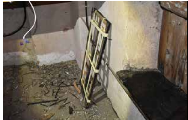
Figur 44. Fönstret placerat i en av ljudluckorna var genomruttet och har bytts ut. Här står det äldre fönstret.
