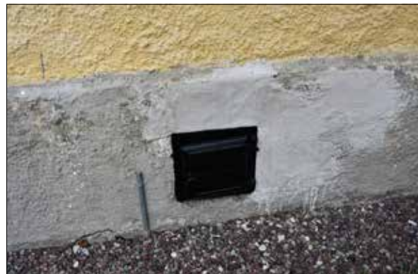
Figur 52. Ventilationslucka. Grunden har totalt nio stycken.
