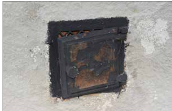
Figur 9. Lucka på ventilationsöppning placerad i grunden före renovering.
