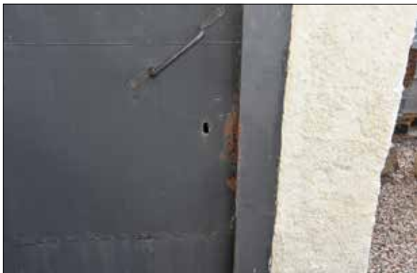
Figur 10. Dörr till källaren hade enstaka rostskador före renoveringen.
