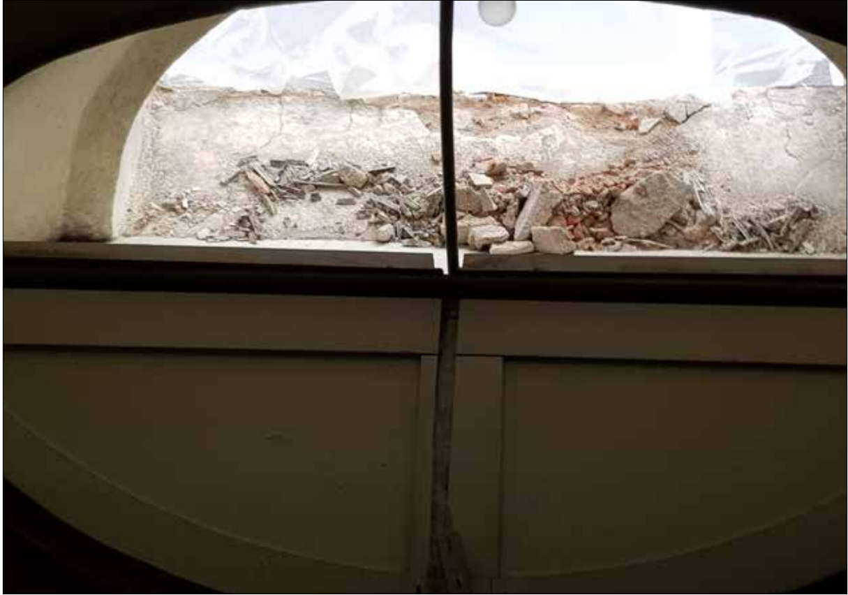
Figur 14. Södra lunettfönstret var monterat bakom en stängd trälucka. Vid besök i september var fönstret på verkstad för renovering. Lägg märke till träluckan som är nedfälld.
