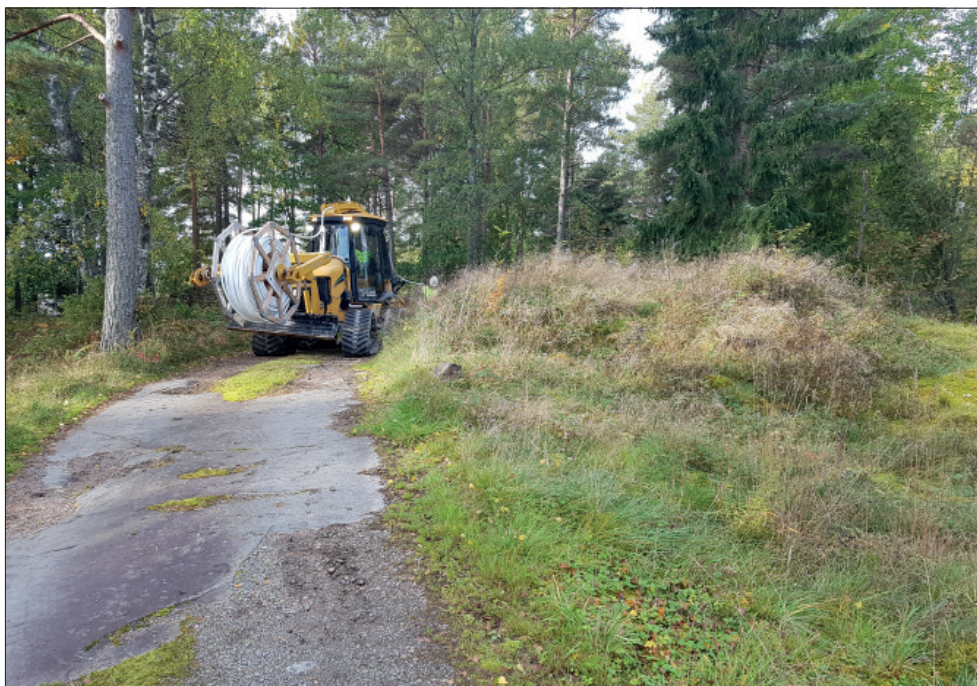
Figur 5. Schaktets avsnitt B, maskinen som användes samt en gravbög. Foto från nordöst.
