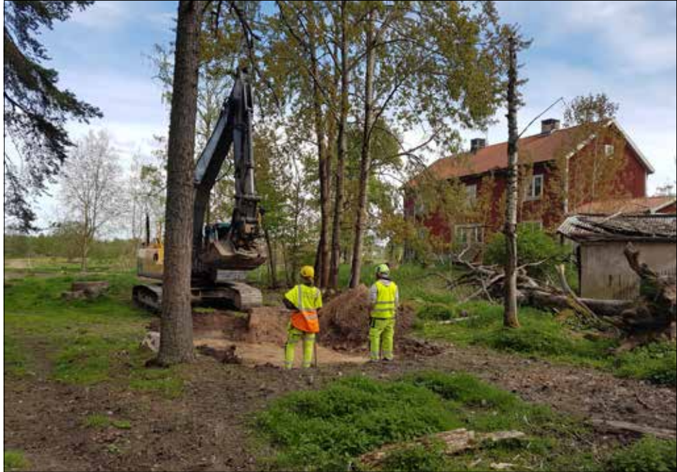
Figur 7. Sofia Lindell och Christian Gatti övervakar schaktningen vid schakt 4. I bakgrunden syns Norra Palmbohults bostadshus sett från nordväst.
