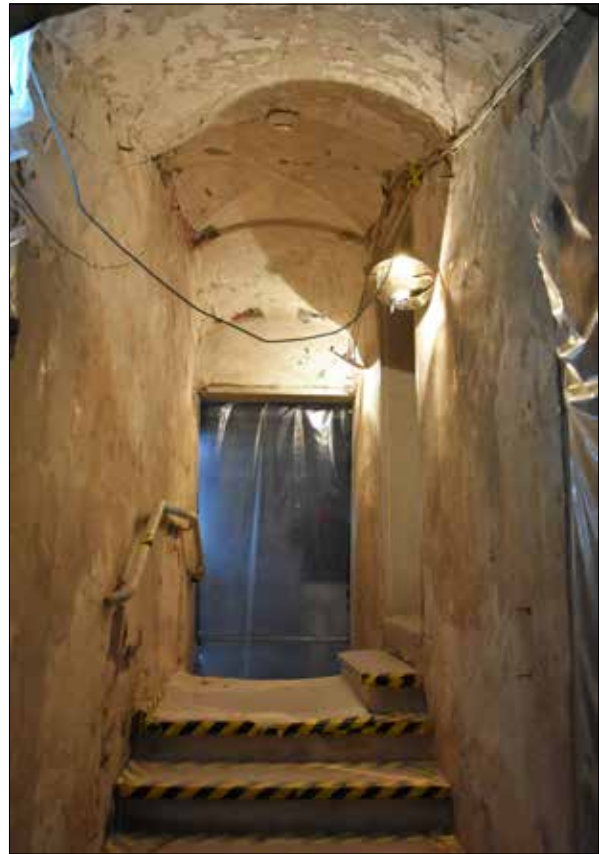
Figur 24. Passagen som leder från koret till sakristian. Skrapning och rengöring pågår, genom att fästa tidningspapper med lim på väggen är det lättare att få med sig smuts och äldre färg.
