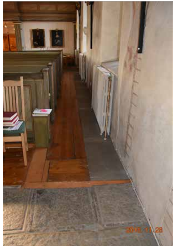
Figur 6. Norra sidogången före upptagning av golvplank. Under befintliga tiljor ligger ledningar som behöver ses över och bytas ut.
