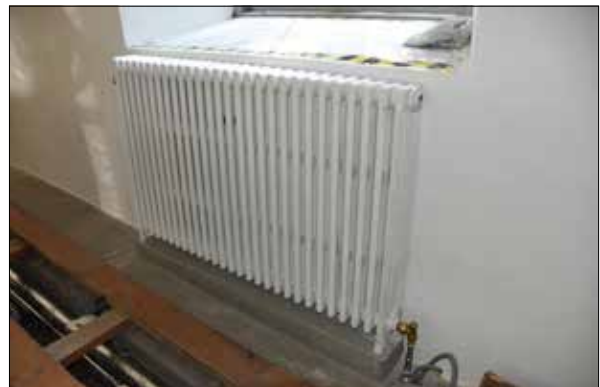
Figur 46. Nymålrad radiator med anslutning på plats.
