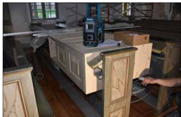
Figur 63. Manöverpanelen på plats men inte målad.
