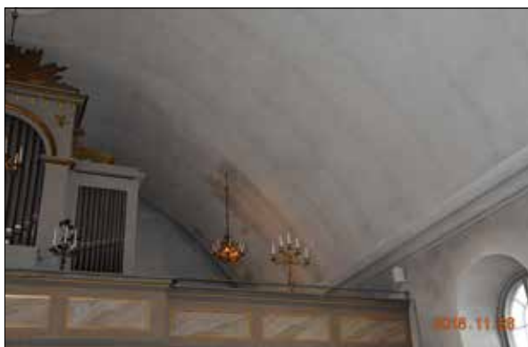
Figur 8. Detalj av taket på norra sidan av läktaren. Lägg märke till en större fuktfläck.
