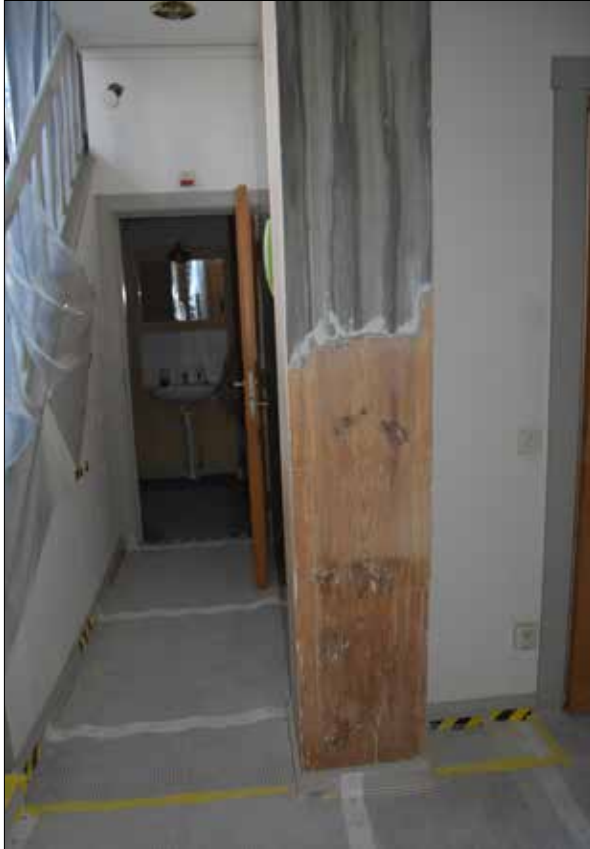
Figur 34 Detalj av pelare som slipats före ommålning, april 2019.
