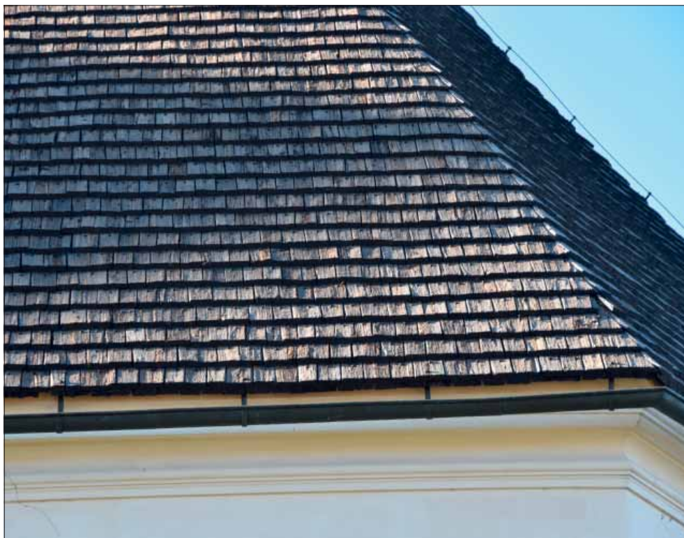
Rättviks kyrka. Äldre, sågade spån från 1900-talets början. Förekommer över hela kyrkan, men återfinns i särskilt stora kvantiteter på koret.
