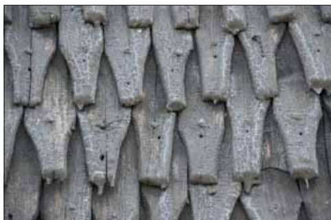
Svedvi klockstapel, närbild på spån på norra fasaden. Mängden spikhål vittnar om att de antingen är återanvända eller att de har demonterats och återmonterats.
