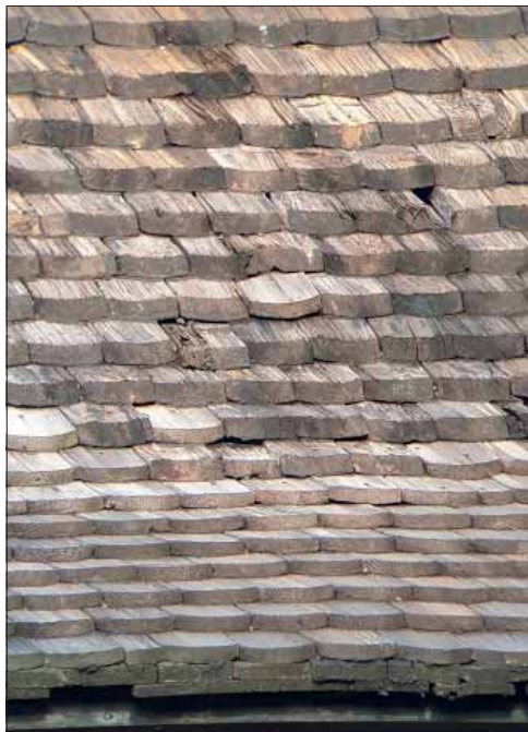
Sala sockenkyrka. På klockstapelns tak ligger eroderade sågade spån. På de nedre flacka partierna har lagningar utförts med sågade spån i tunnare dimensioner.
