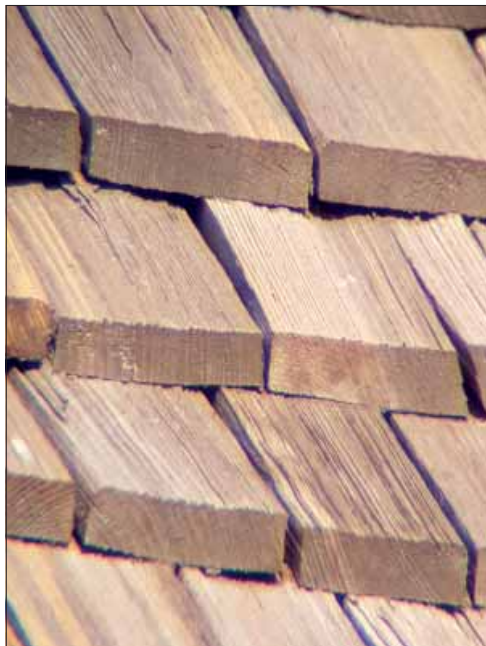
Äppelbo kyrka. Närbild av ett parti på långhusets södra takfall, till sin helhet omlagt senast 1997.
