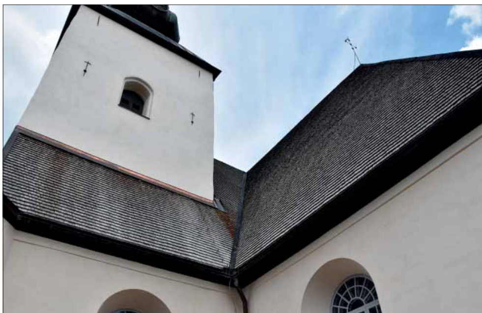
Malungs kyrka. De flesta av kyrkans takfall är täckta med raka spån med kluven ovsida.
