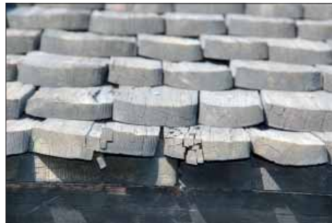
Sura gamla kyrka. Klivna takspån från 2003 med rötskador och sprickbildning.
