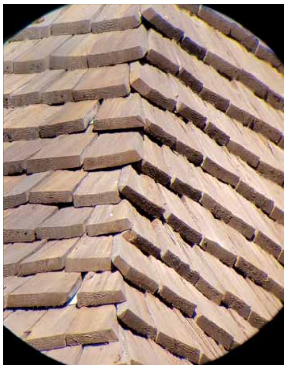
Dala-Floda kyrka. De klyvda spånen på takfallen är från omläggningen 1995. Växelvis läggning är tillämpad över takfallens skarvar.
