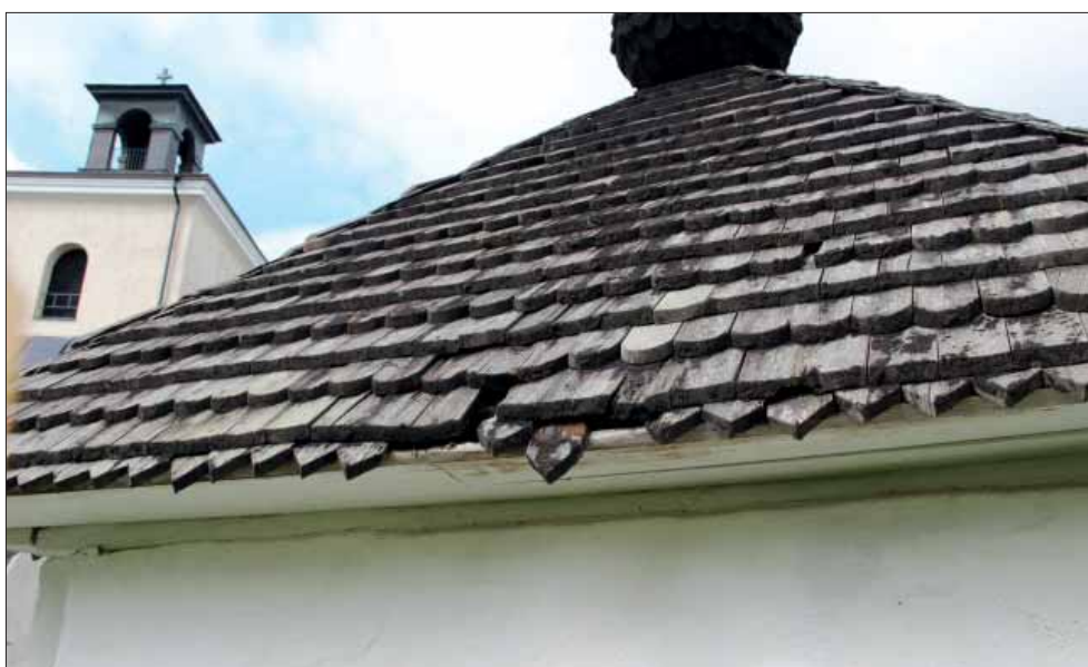
Tillberga kyrka. Rötskador i norra sticluckans spåntäckning.
