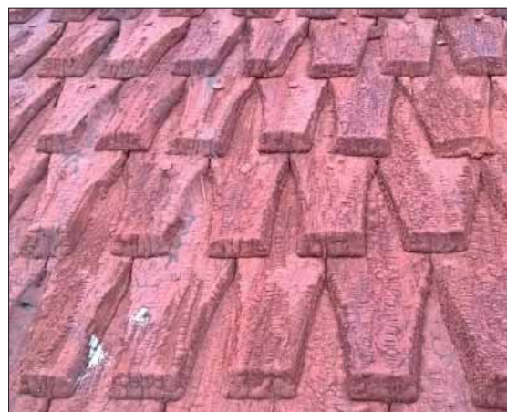
Leksands kyrka. Över 300 år gamla huggna spån från yttertaketets tillkomst 1709—15 återfinns på korets nordöstra och östra takfall. Lika gamla spån skall finnas på lökspirans underdel enligt den kartering som gjordes i samband med takomläggningen 1996. Foto Lars Jönnes.
