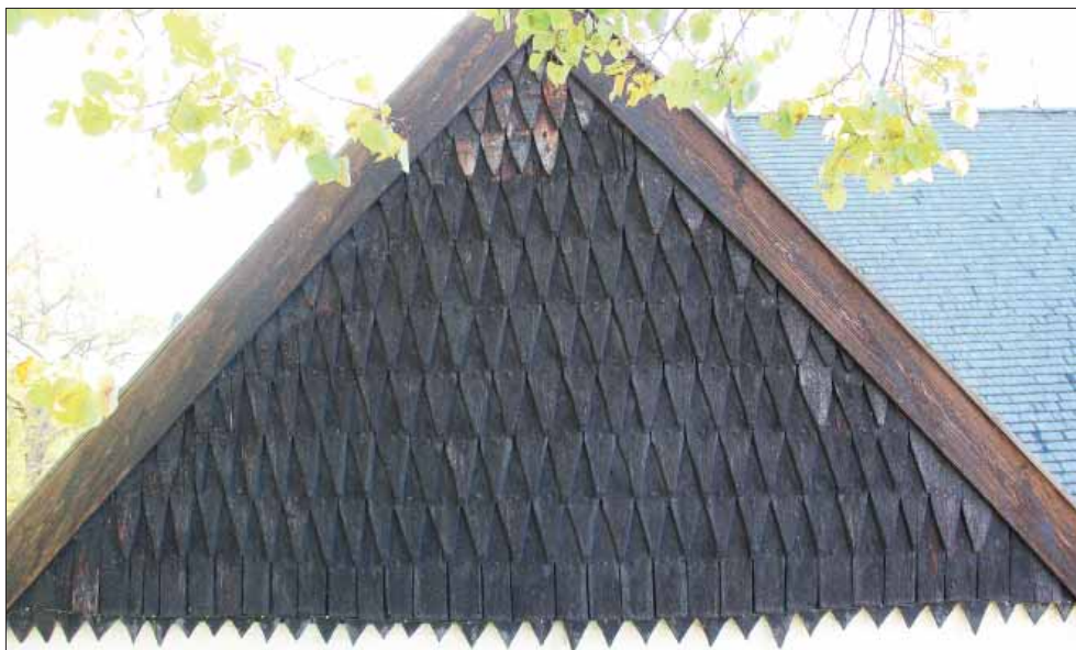
Figur 31. Tångeråsa kyrka, Strängnäs stift. Bild på sakristians gavelspets vars spån bedöms kunna vara från sakristians uppförande omkring 1450. Spånen är tillverkade med omsorg i jämn storlek vilket skapar symmetri i läggningen. Spånens spetsar är mycket noggrant gjorda med helt raka sidor utan antydning till svängar åt något håll. Att hugga alla spån till samma bredd innebär inte bara ett slöseri med material, det för även med sig en hel del merarbete. I praktiken innebär det att alla smala spånämnen som normalt hade använts sorteras bort. Likaså får de ämnen som skulle kunna ge breda spån huggas ner till en smalare form. Spåntäckningen berättar att ett viktigt mål i slutresultatet är att det rombiska mönstret ska följa räta linjer. Foto Lisa Skanser.
