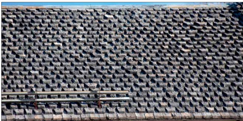
Ore kyrka. Takfall på kyrkans södra korsarm. Här finns spån med äldre tjärrester.
