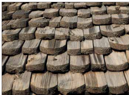
Kärbo kyrka. Spån på sakristians östra takfall.
