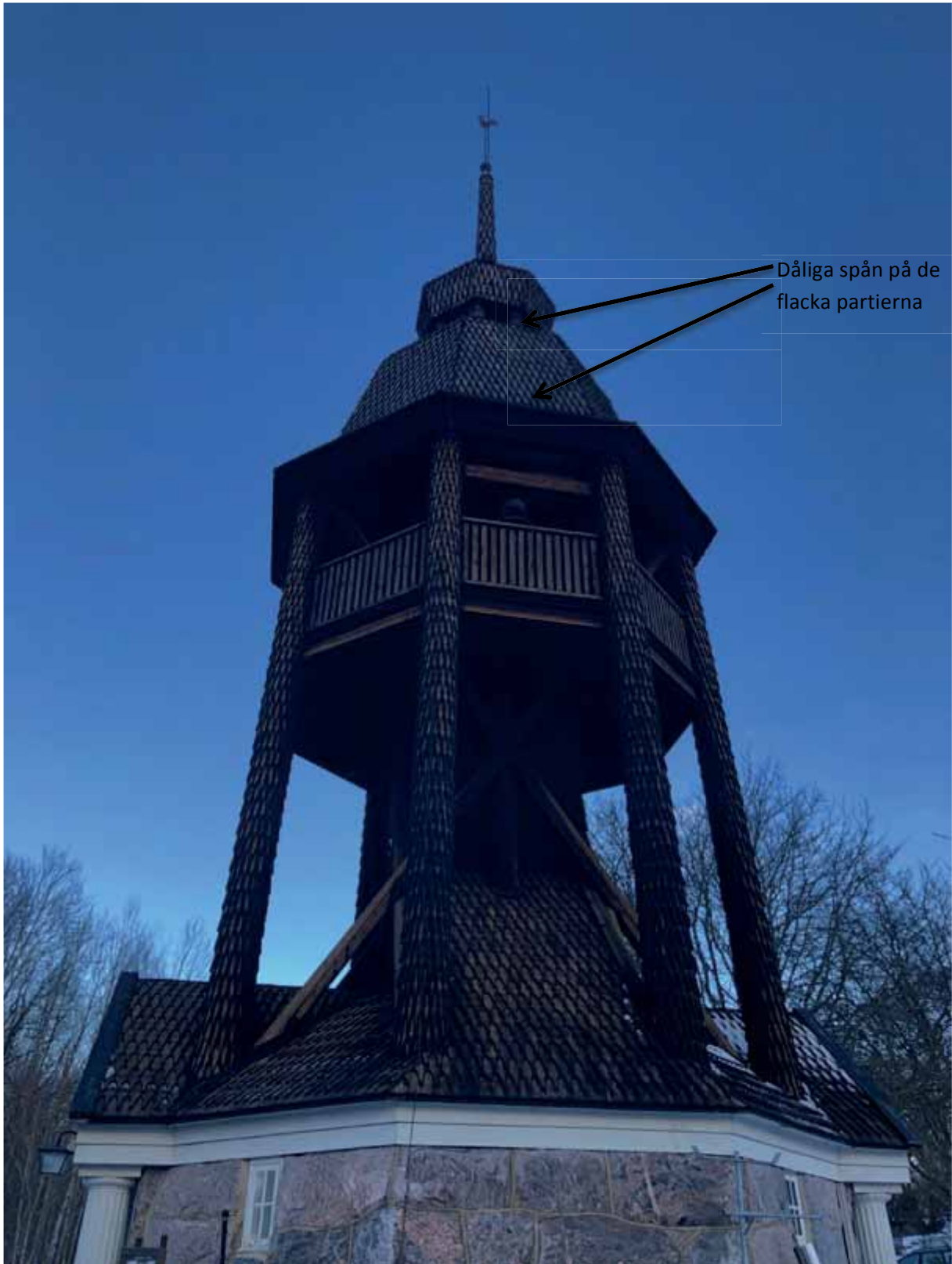
Söder. De nedre takytorna har enstaka dåliga spån, framförallt på västra takkupan.
