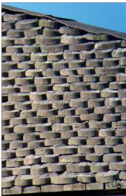
Sala sockenkyrka. På korsarmens övre takfall mot öster ligger kluvna spån uppskattningvis lagda sent under 1900-tal eller tidigt 2000-tal.
