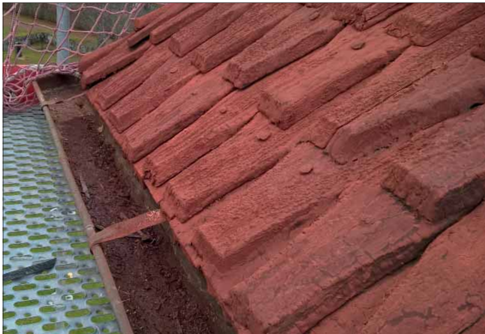
Leksands kyrka. 1700-talsspån vid takfoten på korets nordöstra takfall (bilden tagen innan åtgärder hösten 2018). Foto Lars Jönnes.
