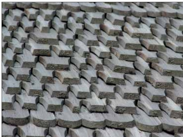
Sala sockenkyrka. På vapenhusets östra takfall lades nya kluvna spån 1998 och enligt entreprenadhandlingarna "spån i likadant utförande som på vapenhusets västra takfall". De visuella skillnaderna är dock stora på grund av att virke, bearbetning, mått, infästning samt tjärans skikt avviker från den östra sidans.
