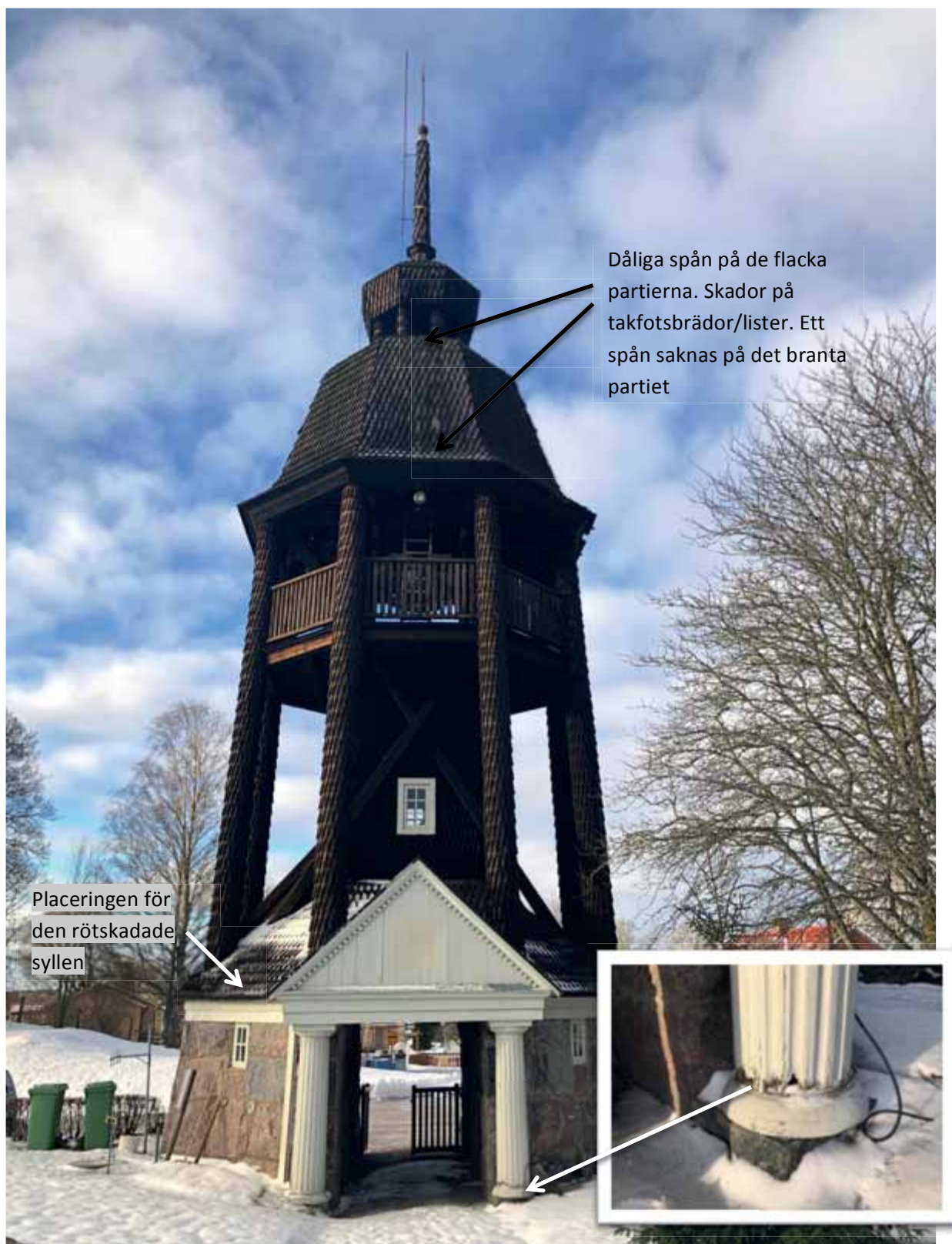
Öster. Norra kolonnen har rötskador i sin nedre del.
