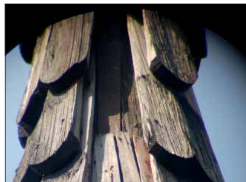
Brukskyrkan i Fagersta, klockstapel. Högst upp på spiran har spån lossnat och röd färg syns på ett av spånen. Det finns risk för att fler spån lossnar och blåser ned.
