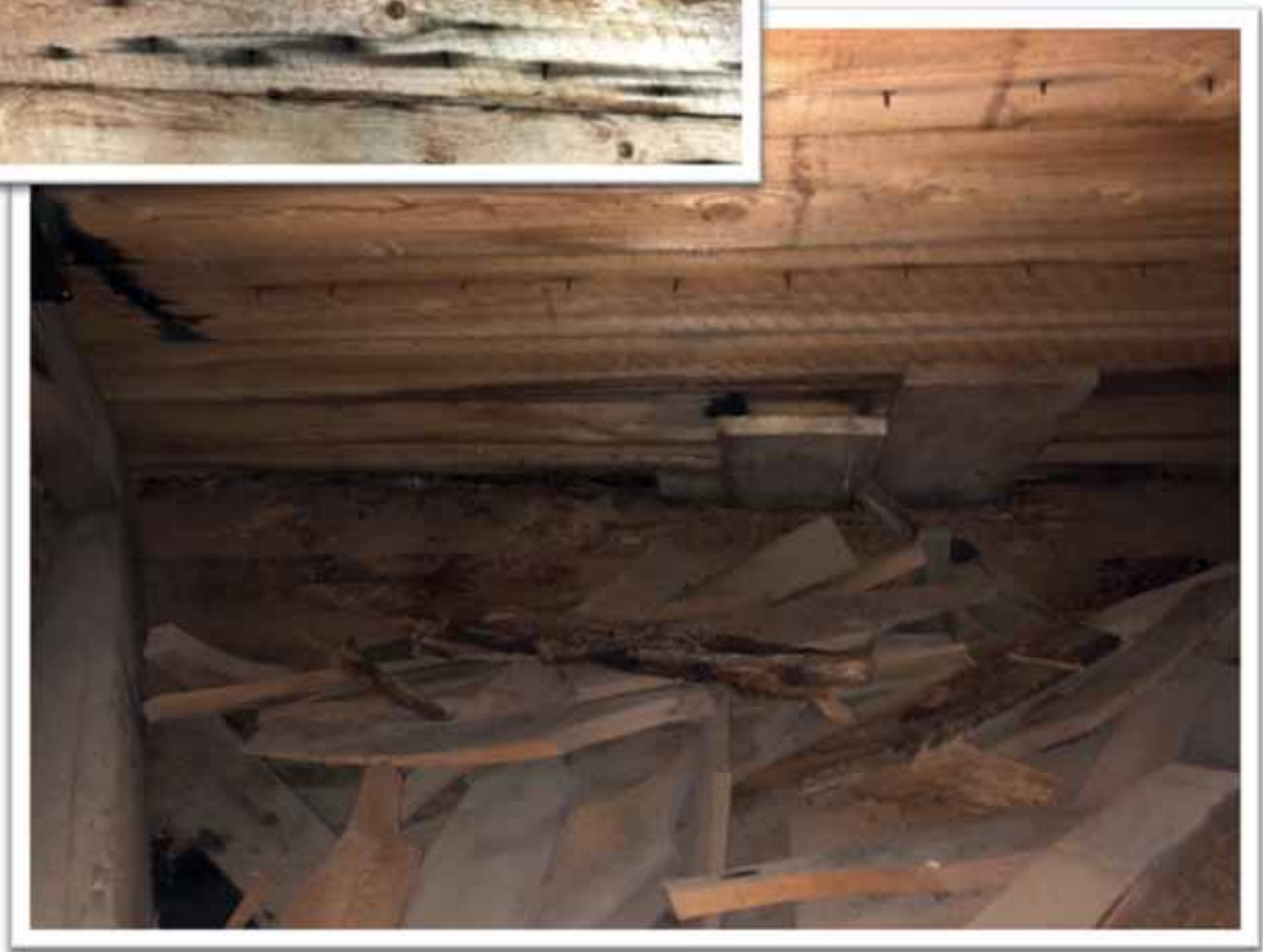
Rötskadad syll på stenfoten, sydöstra sidan. Undertaket har en tidigare lagning.
