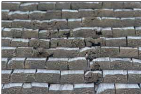
Bergs kyrka. Östra takfallets kluvna spån. Rötskador synliga.
