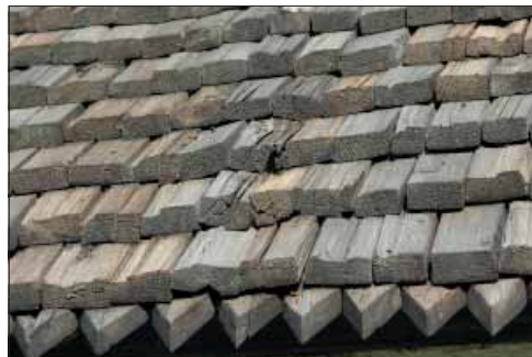
Bergs kyrka, bårhus. Västra takfallets kluvna spån. Rötskador och splintved är synligt.
