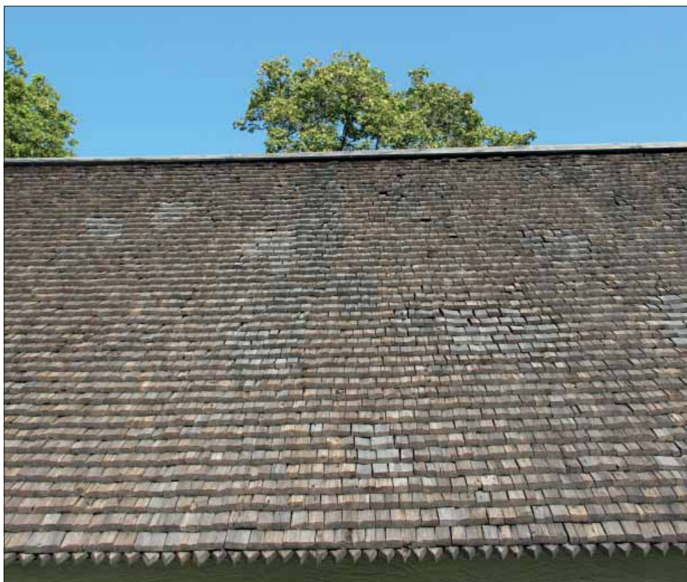
Bergs kyrka. Västra takfallets kluvna spån. Partier med ilagningar synliga.
