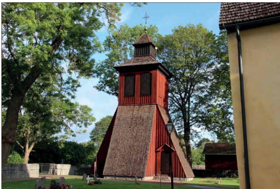
Sala sockenkyrkas klockstapel från söder. Två olika typer av spån finns på fasaderna. Åt väster sitter sentida klyvda spån. Övriga fasader har sågade spån spikade på tjärpapp, de kan vara från 1960-tal eller däromkring.
