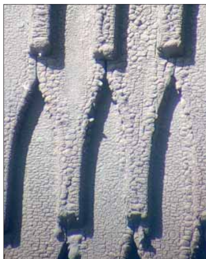
Figur 57. Västermo klockstapel, Strängnäs stift. Sannolikt ursprungliga spån från 1914 med tjockt krackelerat tjärskikt. Foto Bengt Bygdén.
