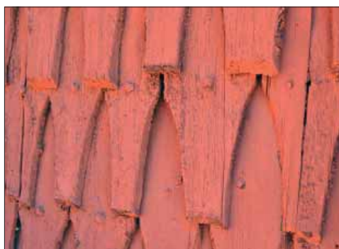
Hosjö kyrka. Detalj av äldre spån på kyrkans västfasad.
