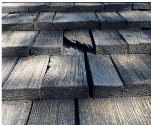
Rytterne bårhus. Södra takfallet på bårhuset. Här finns trasigt spån med kvist.
