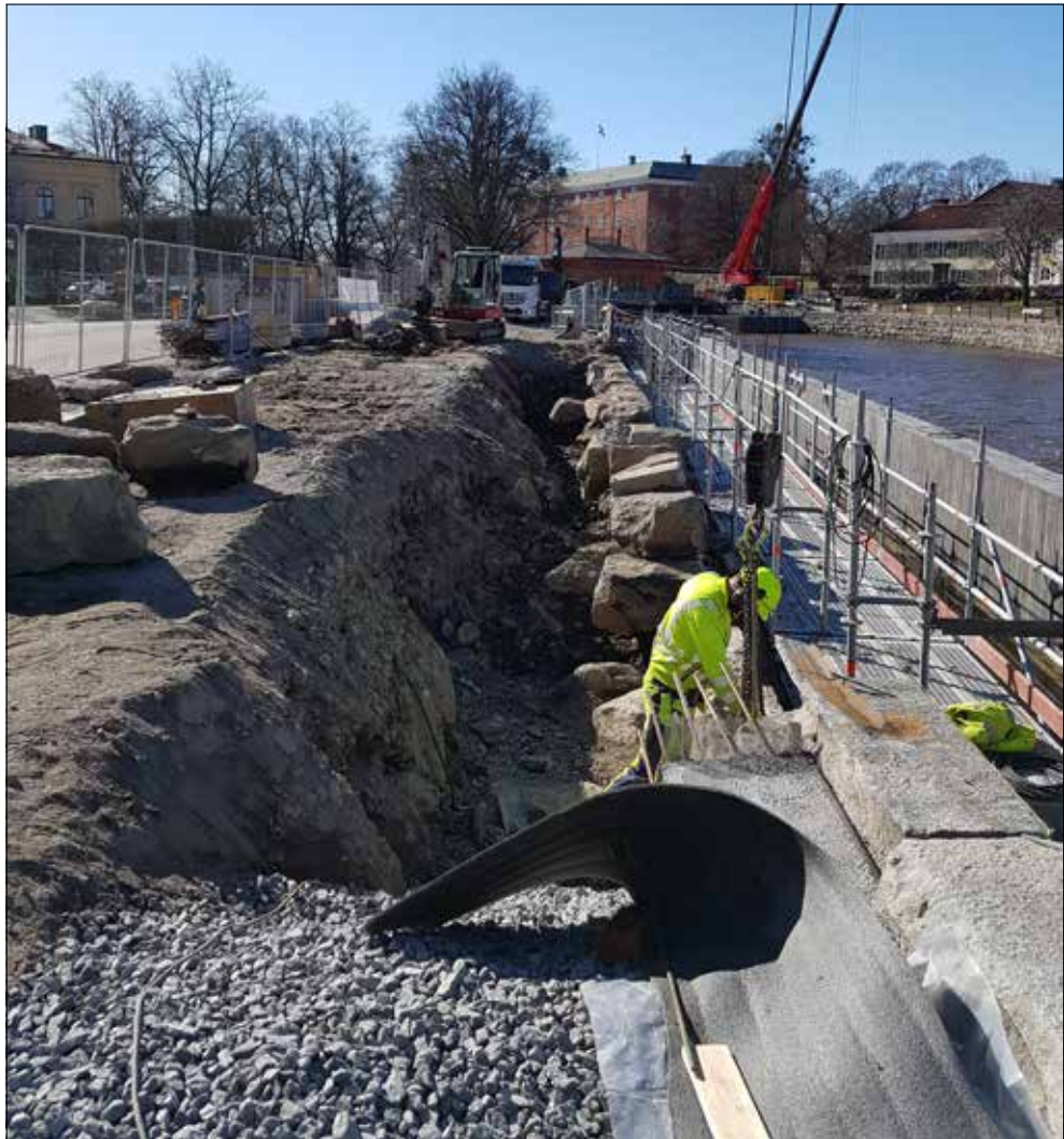
Figur 20. Schakt 1 längs med Fiskartorget. Här har utrymmet bakom stenskoningen schaktats ur för att förstärka stenskoningen bakifrån. Svartån syns till höger. Bakom lyftkranen i bakgrunden syns Västerås slott från 1300-talet. Framför slottet ligger Turbinhuset. Foto från norr av Jonas Ros.
