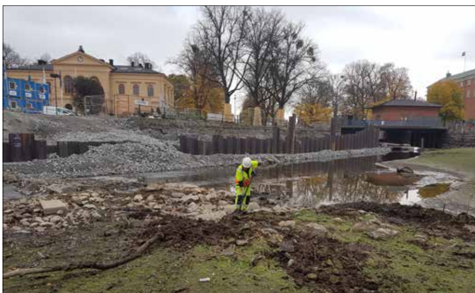
Figur 3. Duncan Alexander i färd med att skotta fram dammvallen A1 inför fotodokumentation. Spontningen för faunapassagen syns bortom vattenflödet. I bakgrunden till vänster syns Västerås gamla rådbus och till höger skymtar slottet bakom Turbinhuset. Foto från norr.
