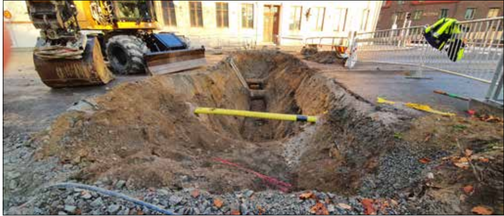
Figur 3. Spår efter markarbete. Flera stora rör syns i den norra delen av schaktet, intill kvarteret Spinnbuset. Jordkabel längst i söder är markerad med rosa sprayfärg, och ett gult rör för el syns strax intill. Foto från söder.
