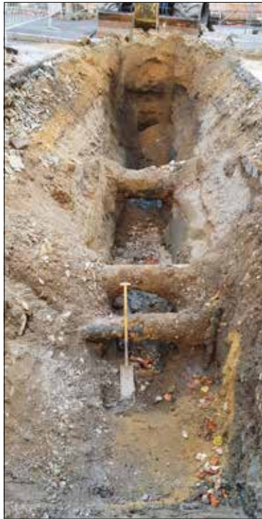
Figur 4. I bilden syns gamla rör för gasledning som idag innehåller fiberkablar. Olika moderna fyllnadslager syns även i profilväggarna. Foto från norr.
