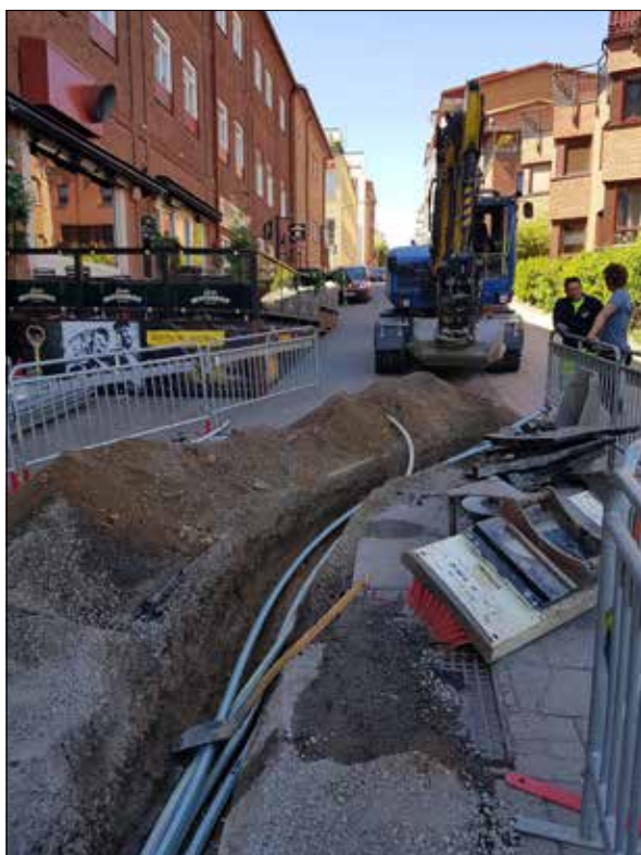
Figur 5. Den västra delen av schakt 300. Bilden visar var i sträckan raseringslagret påträffades. Foto från öster av Viktoria Björkhager.
