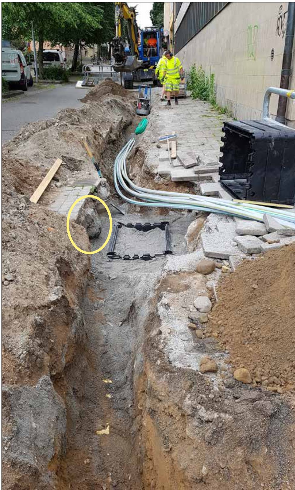
Figur 9. Olai Kyrkogata. Delar av busgrunden syns till höger om brunnen, markerat med en gul ring. Ett rör för anloppsvatten syns strax söder om stenen. Foto från norr av Karolina Karlsson.
