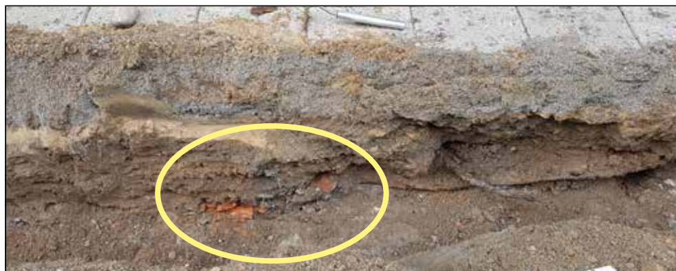
Figur 11. Lager 351 i schakt 538, markerat med en gul ring. Delar av en äldre kabel för el syns i schaktkanten. Foto från norr av Karolína Karlsson.
