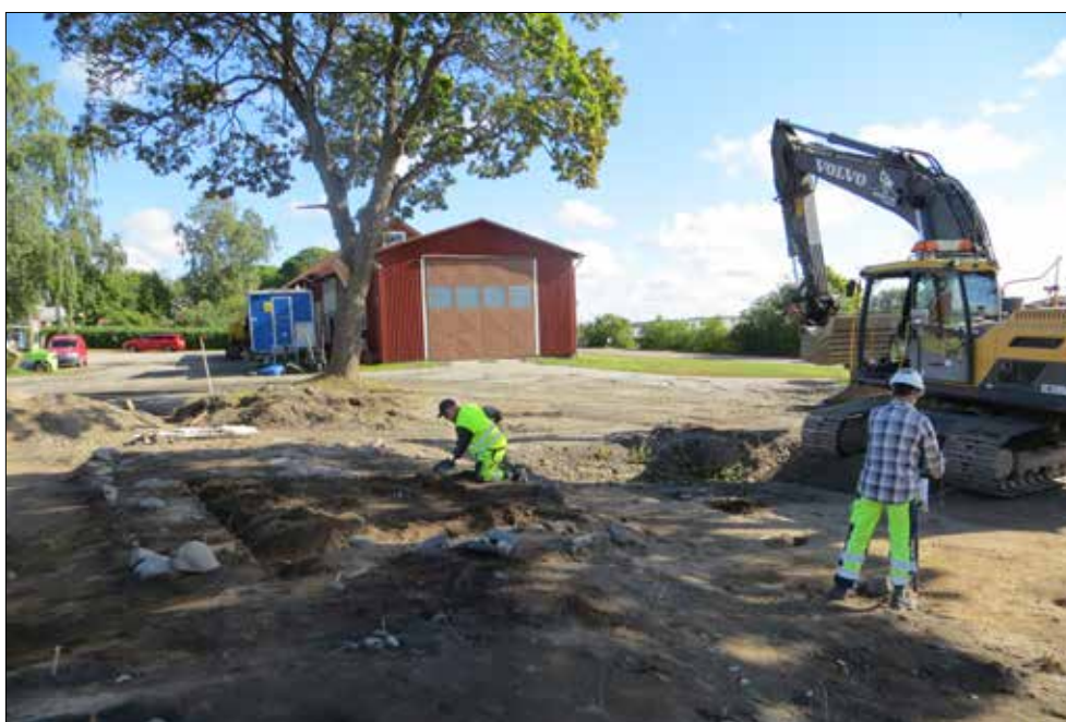
Figur 13. Jonas Ros och Reidar Magnusson undersöker husgrunden, dels för band, dels med hjälp av maskin. Foto från söder av Andrea Olausson.
