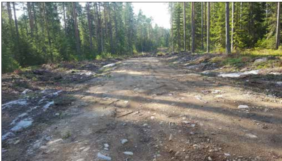
Figur 3. En ny skogsbilväg var under byggande i östra delen av utredningsområdet. Foto från norr av Jenny Holm.
