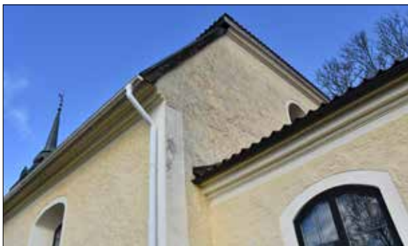
Figur 12. Utsikt uppåt, östra gaveln. Lägg märke till övre takfotsbrädans vita kulör före renovering. Se också hur sliten och smutsig fasaden är.
