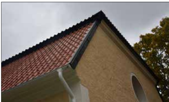
Figur 47. Detalj av takfotsbräda målad i svart kulör. Takfot och släta putspartier har NCS S 0603-Y20R. Stuprör vita.
