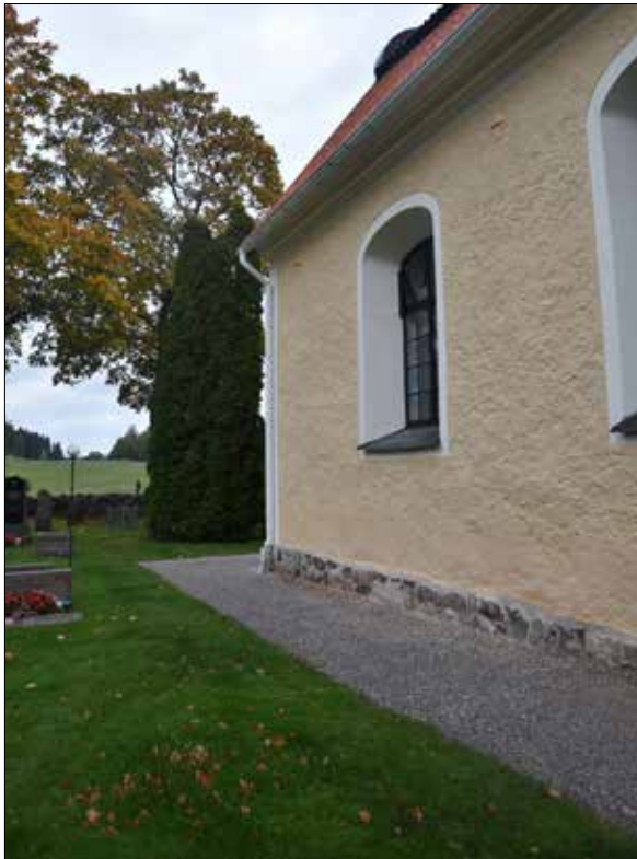
Figur 50. Södra fasaden, hörnet mot väster. Två dragtagsplattor, knappt synbara på håll.
