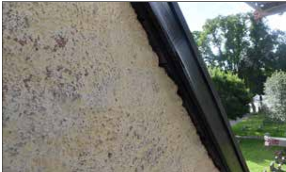
Figur 26. Utbytt och målad takfotsbräda, västra gaveln.
