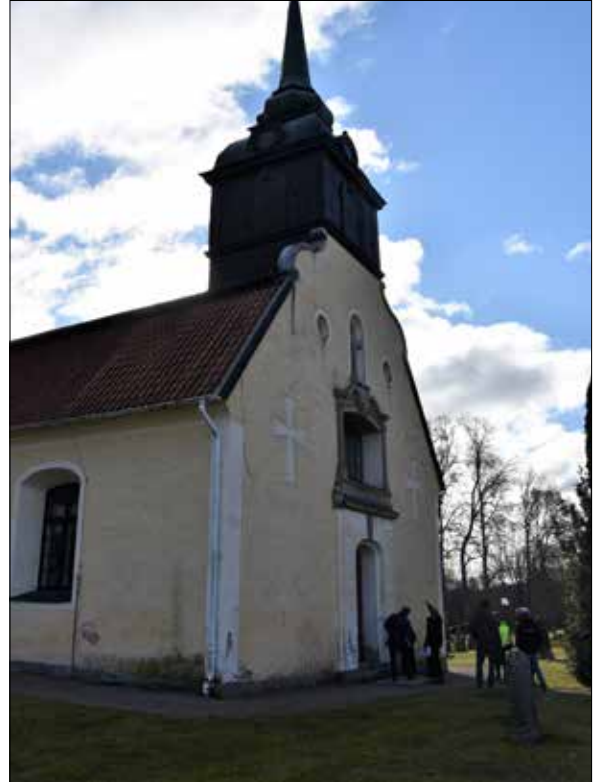
Figur 9. Västra gaveln före renovering. Lägg märke till stenarbetena som ger ett smutsigt och slitet intryck även på långt håll.
