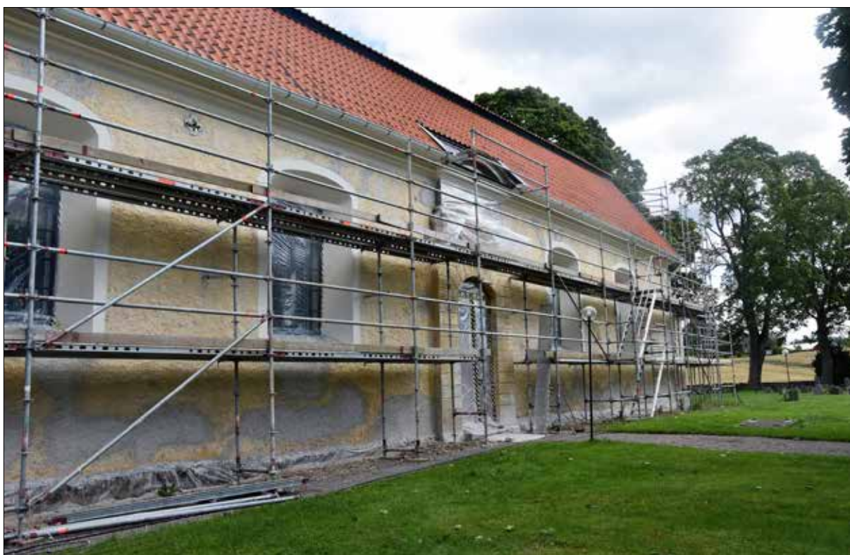
Figur 31. Södra fasaden vid platsbesök i augusti. Lägg märke till dragstagsplattan som framträder på fasaden. Fasadytan som lagades/putsades om blev större än vad man först räknade med.
