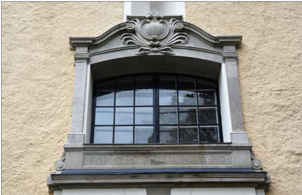
Figur 43. Slutbesiktning, september 2021. Detalj av renoverade stenarbeten ovan västra entrén. Från marken ser man inte tillkomna plåtarbeten.
