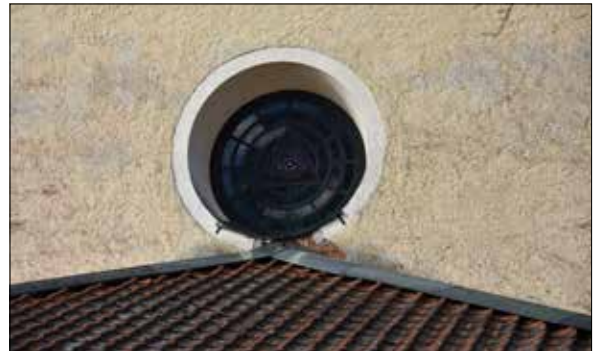
Figur 11. Detalj av korfönster med putsbortfall, östra fasaden.
