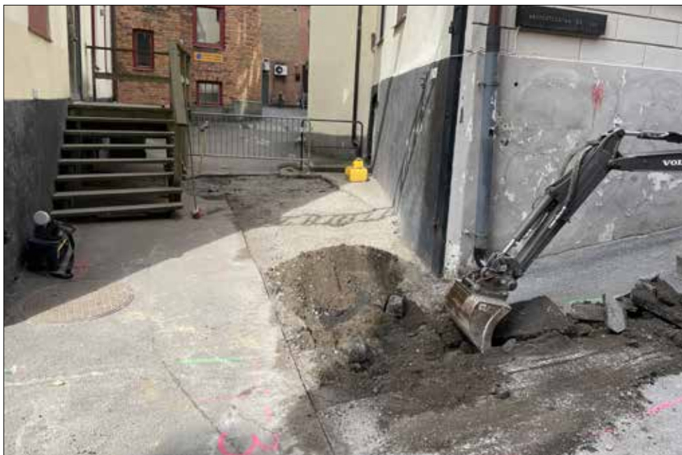
Figur 3. Södra delen av undersökningsområdet från öster i samband med att schaktningen började.
