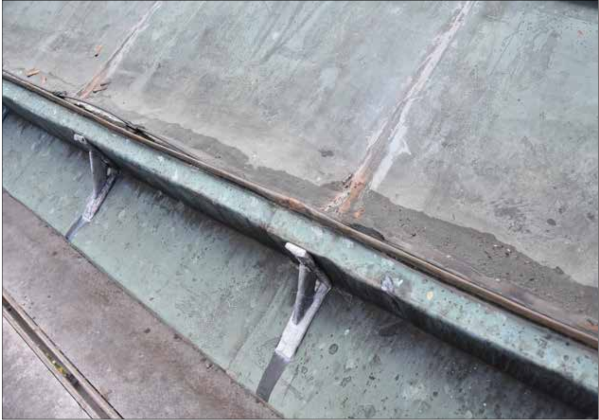
Figur 24. Detalj av lödning och konsoler åter på plats. En konsol har bytts ut och sex nya kopparspikar har tillkommit vid renovering.
