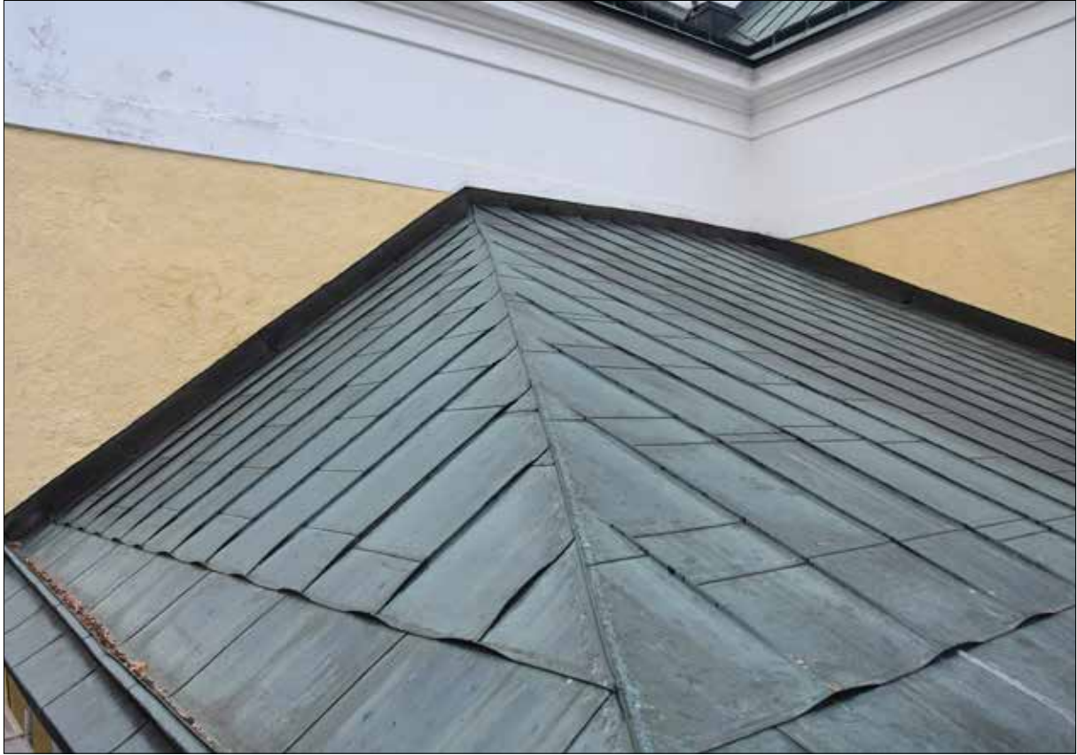
Figur 22. Utblick över taket vid slutbesiktning i oktober 2021. Plåten sluter nu bättre mot fasaden och öppna falsar har tillslutits.
