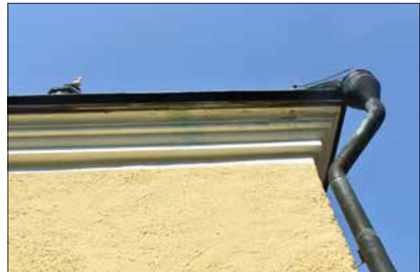
Figur 5. Vattkupa och stuprör, lägg märke till takfoten som uppvisar rinningar.
