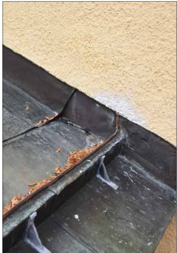
Figur 21. Slutbesiktning den 21 oktober 2021. Putsen har blivit lite skadad i samband med åtgärder.
