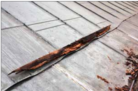
Figur 11. Detalj av rötskadad bräda.
