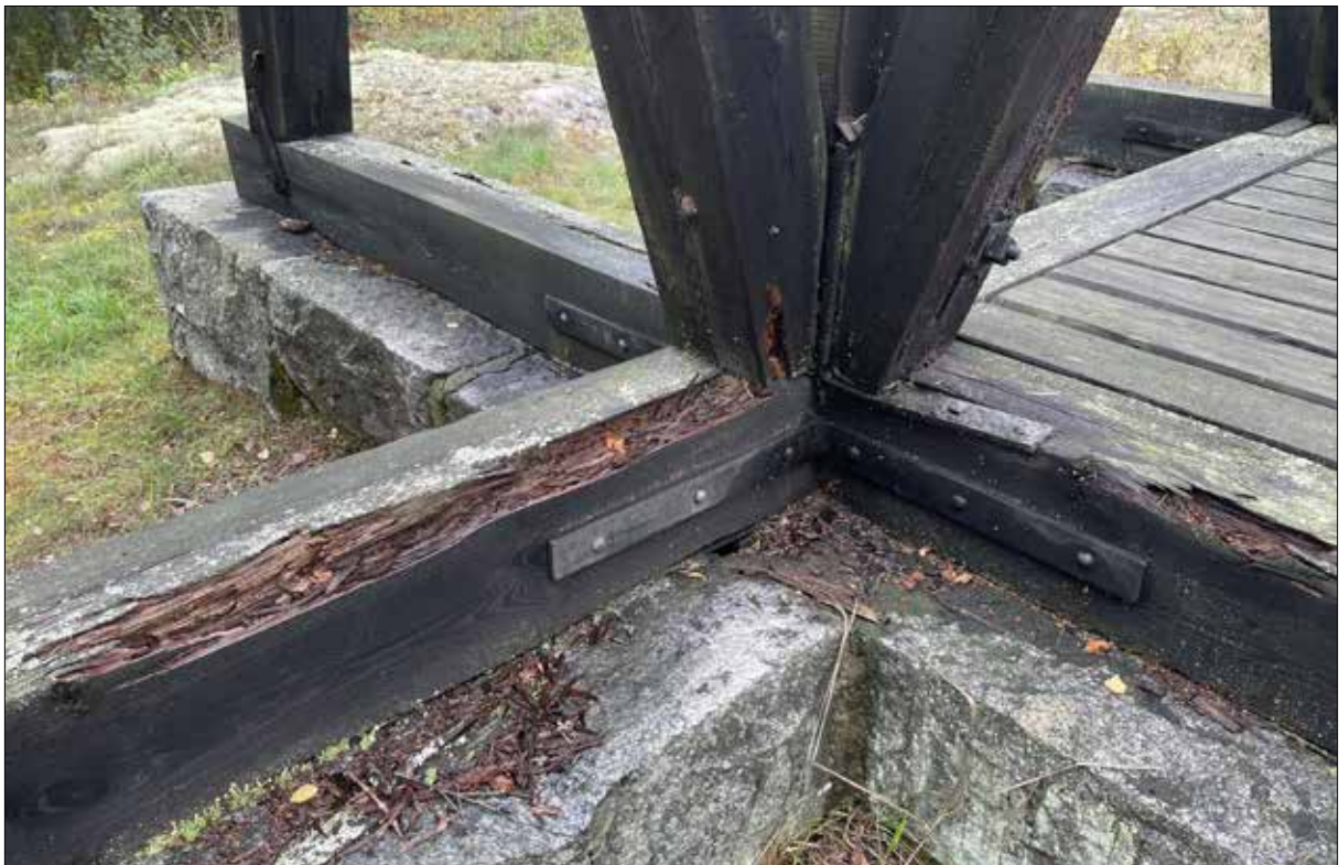
Figur 10. Före renovering, syllstockar behöver bytas helt.
