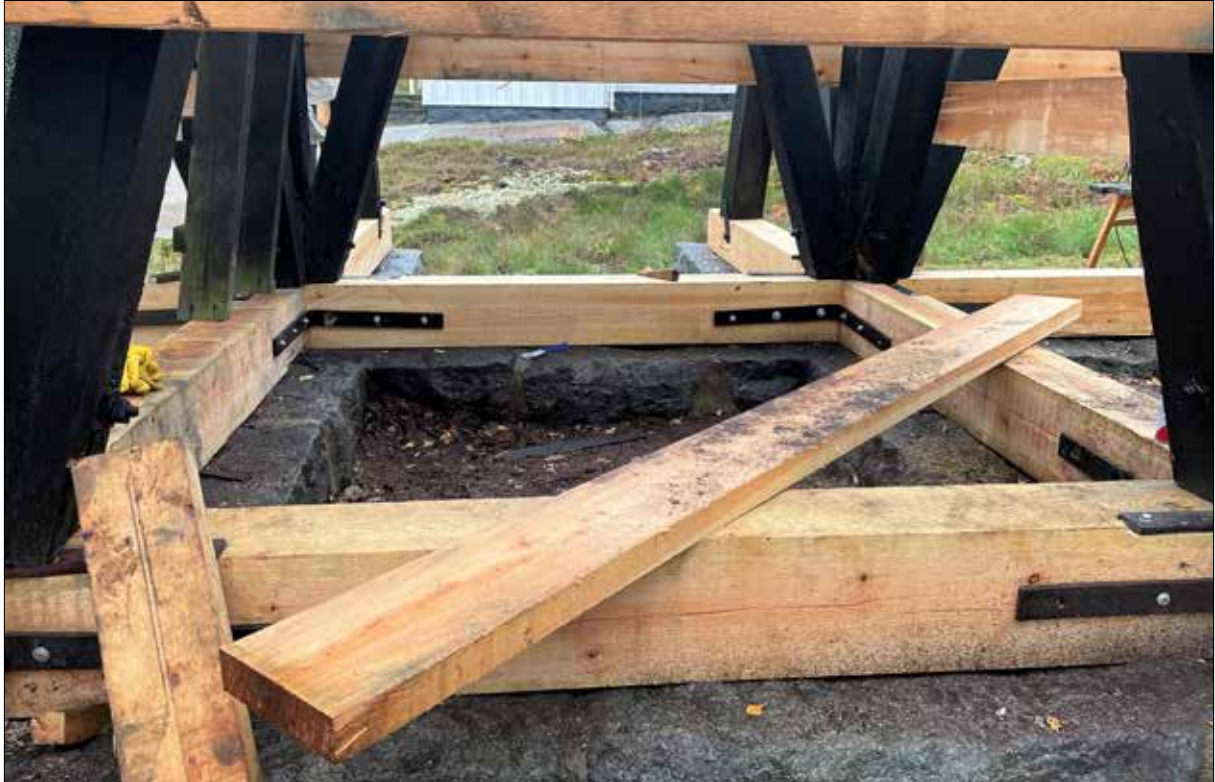
Figur 15. Andra byggmötet den 20 oktober. Utsikt mot öster. Syllarna utbytta och stenbällar rengjorda.
