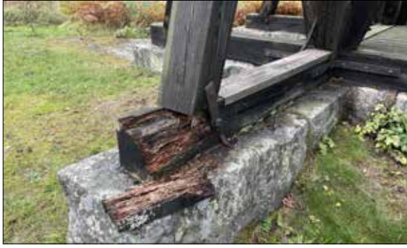
Figur 7. Detalj av rötskadad syll före renovering, oktober 2021.
