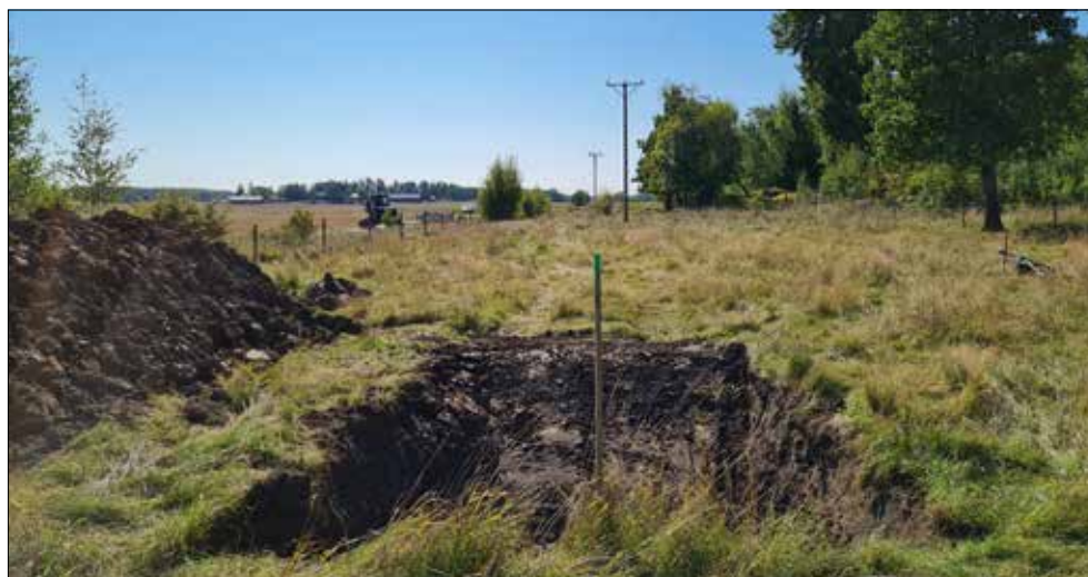
Figur 16. Den planerade kabelsträckan sträckte sig ner till den första ledningsstolpen. Foto från norr.
