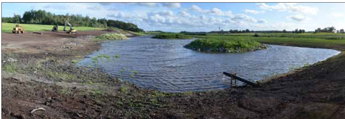
Figur 6.39. Norra delen av dammen efter det att avlopp/inloppsrör med munk anlagts, vattnet har släppts på och stiger långsamt. Till vänster i bild återfinns de planerade och släntade resterna av norra ytan. Vy mot söder.
