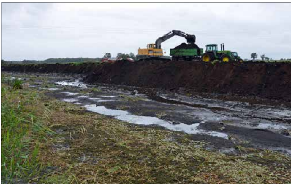
Figur 2.2. Schaktning för anläggande av våtmark i Tjugestamossen vid Stora Tjugesta 2018. Ytan med vass och vattenväxter, närmast kameran, var en sedan tidigare anlagd damm. Bortanför den torrlagda dammen schaktas den intakta lagerföljden av torv och gyttja bort för att utvidga dammen.
