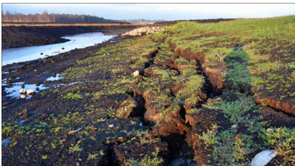
Figur 6.22. Vid besöket i november 2018 hade kanten av schakt 3 påverkats av ett skred. Skredet kom att förvärras ytterligare under vintern (jfr figur 6.29).
