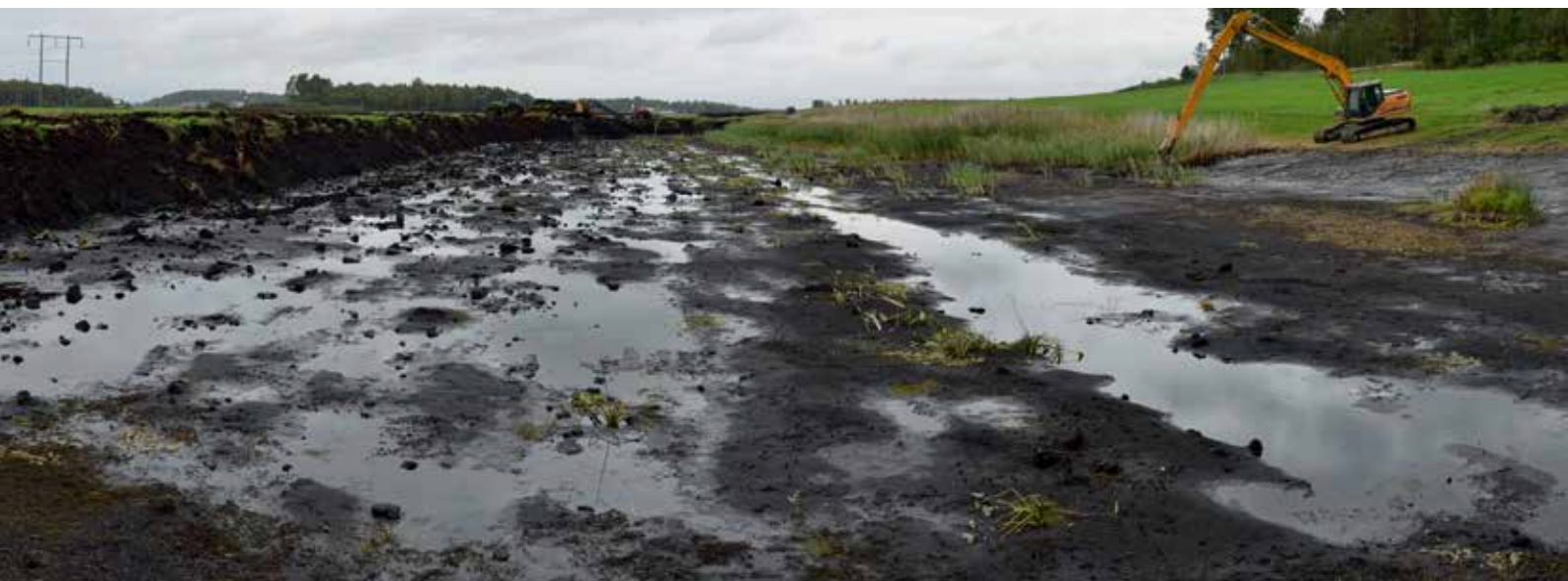
Figur 2.3. Schaktning för anläggande av våtmark i Tjugestamossen vid Stora Tjugesta 2018. Ytan med vass och vattenväxter, till höger, var en sedan tidigare anlagd damm. I samband med schaktning av kringliggande ytor torrades dammen och rensades på vegetation. Ytan till vänster schaktas här för första gången.
