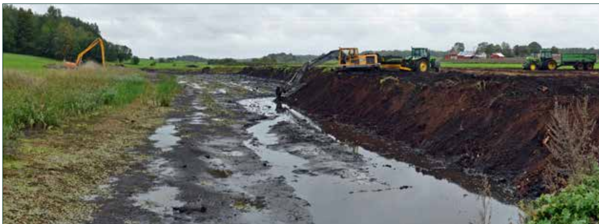
Figur 6.12. Schaktning inom den sydöstra delen av den planerade dammen. Vy mot söder.
