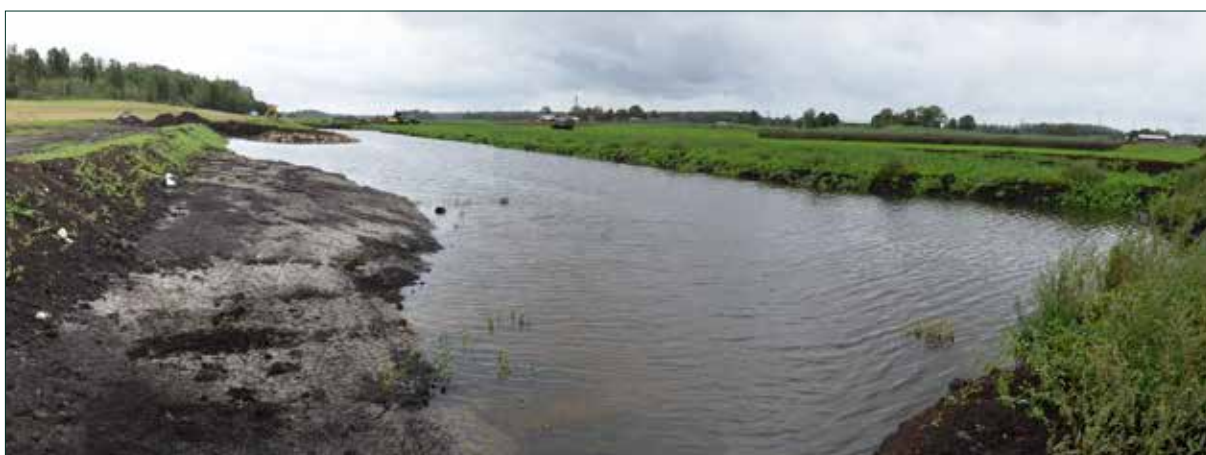
Figur 6.13. Vid besiktningen den 11 september 2018 så var både schakt 1 och 2 vattenfyllda. Vy mot söder.
