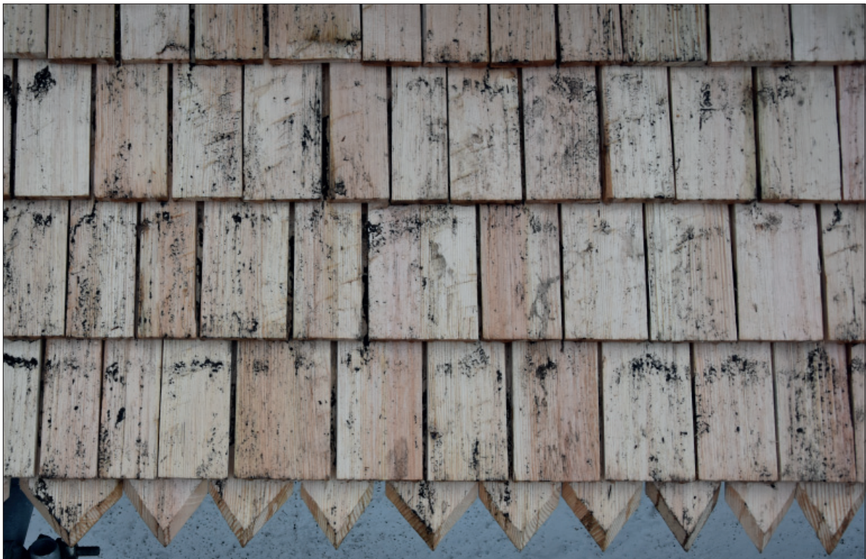
Figur 29. Detalj av takspån. Arbetet ser mycket bra ut med mellanrum mellan varje spån och snygg avslutning.
