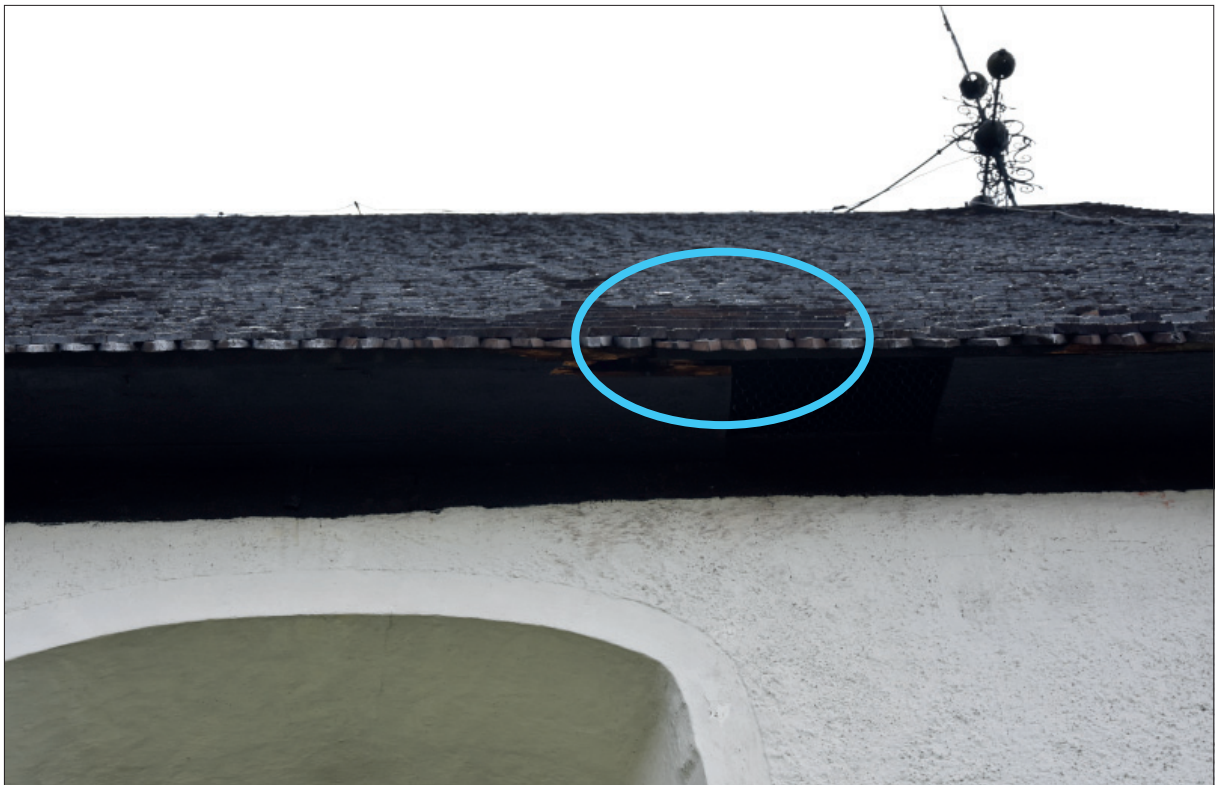
Figur 4. Detalj av takfot, hösten 2020. Den blå markeringen visar att takfoten har öppna hål samt att del av takfoten är rötdad.
