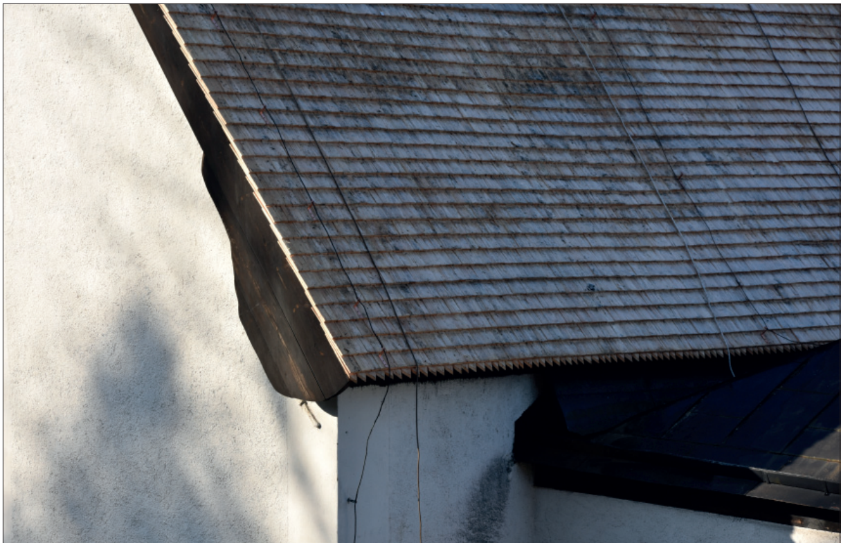
Figur 37. Spånens överhäng mot vindskivan är mindre än på södra takfallet, vilket är svårt att fånga på bild.
