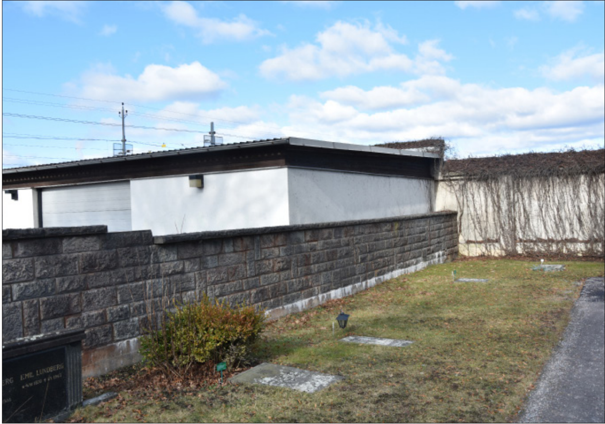
Figur 7. Startmöte 2021-03-04. En solig dag, tittar vi på senmuren mot nordväst. Här ses muren före renovering.
