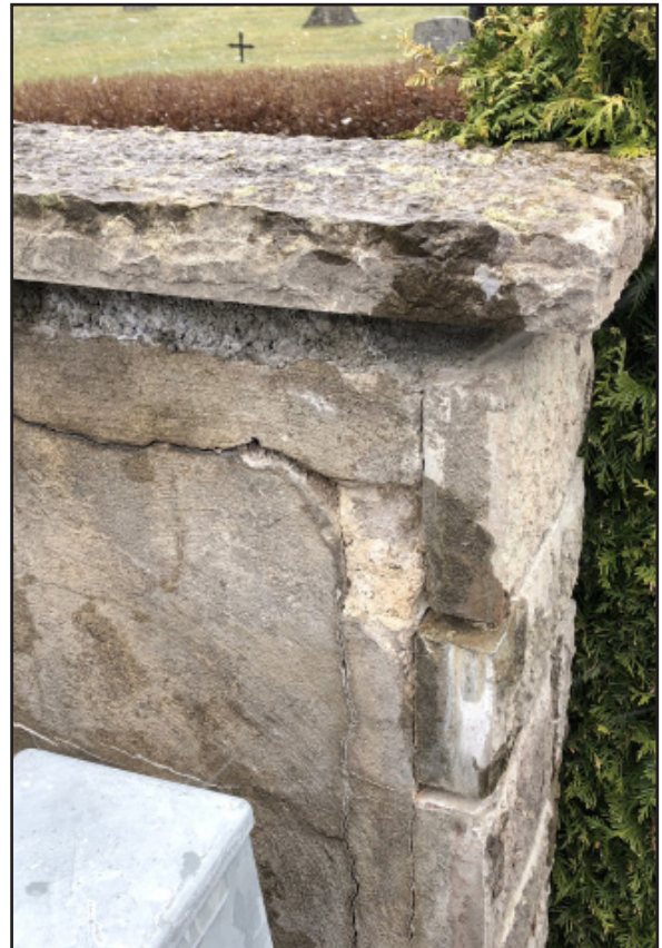
Figur 15. Detalj av skador.
