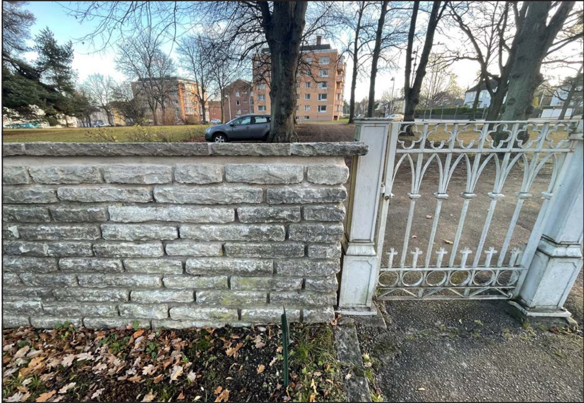
Figur 29. Slutbesiktning noveber 2022. Här ses tydligt att locken lutar från bakkant till framkant med 30 mm. Detta medför att vattnet rinner av i stället för att samlas på locket.
