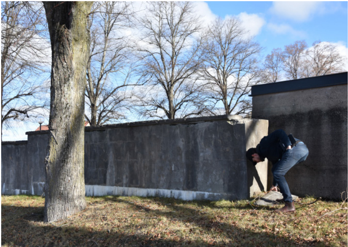
Figur 12. Baksidan av muren är putsad och har en del sprickor. Ett trasigt lock har ramlat ner.
