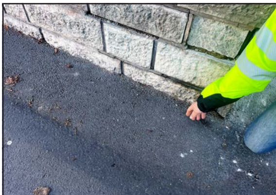
Figur 34. Ny asfalt mot muren ser inte bra ut.
