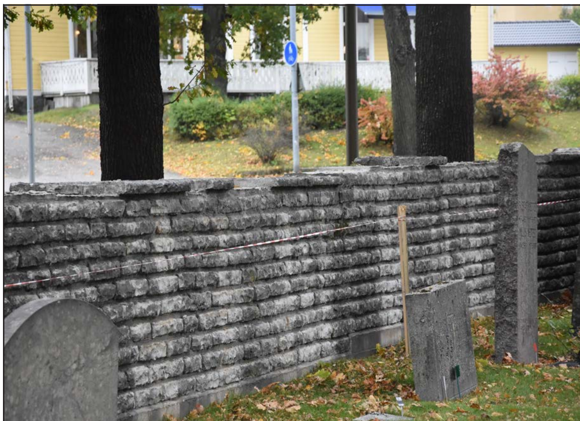
Figur 21. Den röda muren. Många lösa och trasiga lock vid platsbesök 2021-09-29.
