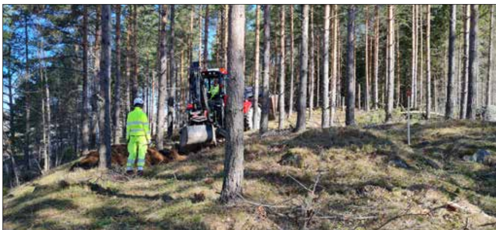
Figur 4. Schakt 375 öppnas. Till höger i bild ses stensättningen A200, där läget för starkströmskabeln syns som en svacka.
