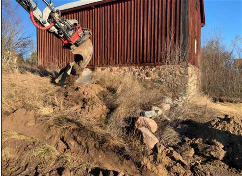
Figur 6. Grävning intill den byggnad med källare som troligen är den enda som finns med redan i kartbilden från 1856 och som ännu står kvar inom Eggeby bytomt. Byggnaden ligger i nordvästra delen av det som varit Västergårdens/Rustbällets tomt. Skulle byggnaden visa sig vara yngre bar den i så fall tillkommit på samma plats som en äldre byggnad och då troligen på samma grund. Notera terrasskanten som löper i en förlängning av den södra gaveln åt väster. Foto från väster.
