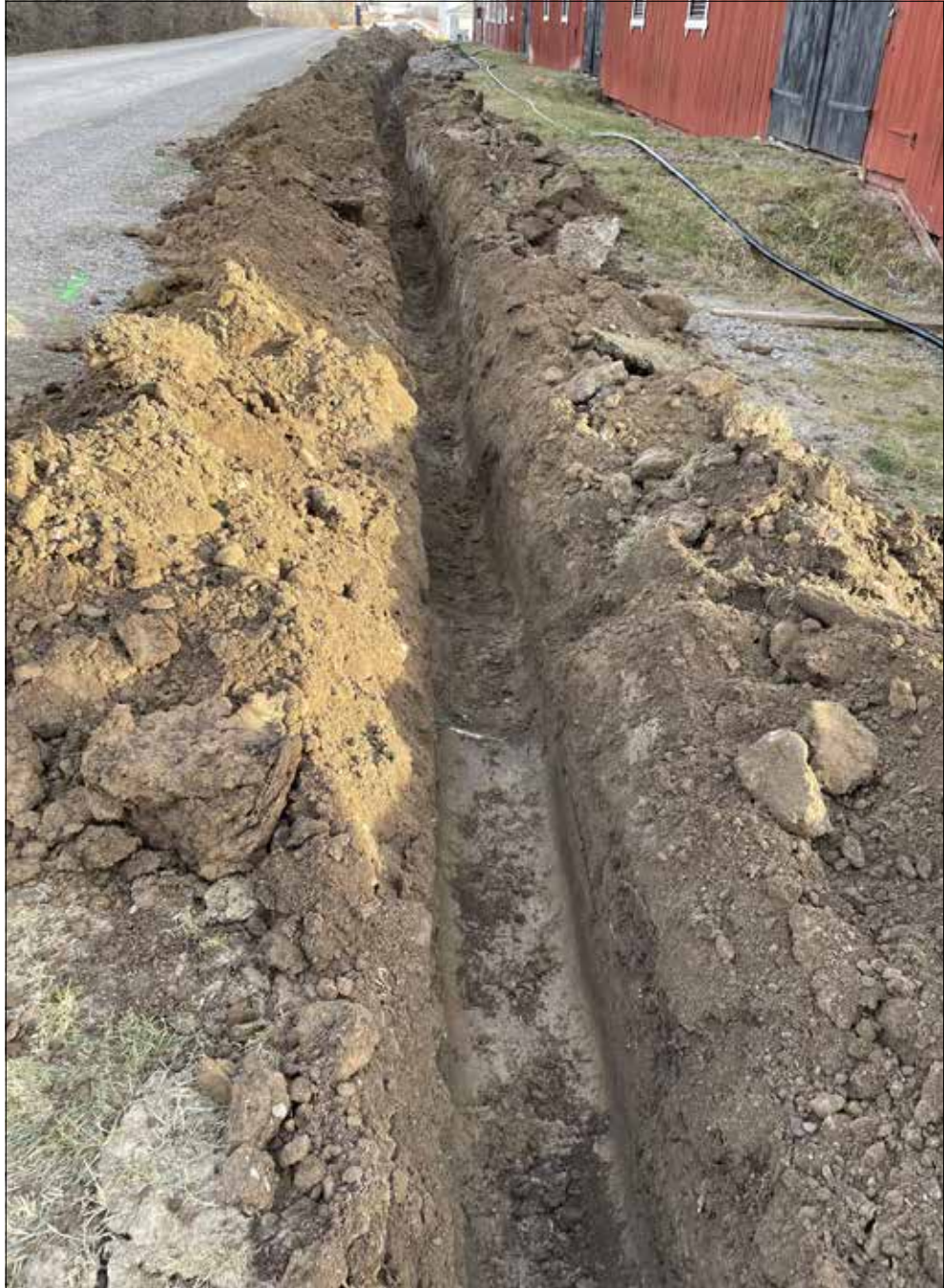
Figur 8. Öppet schakt grävt längs södra sidan av bytomten. Foto från väster av Fredric Wirbrand.
