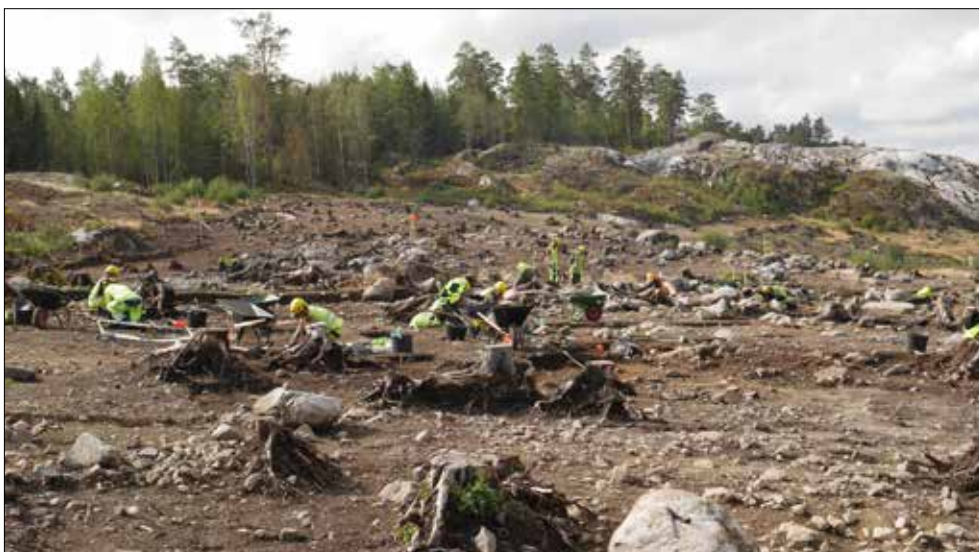
Figur 24. Rutgrävningen har avslutats och anläggningsgrävning pågår. Den underliggande steniga moränen framträder. Foto Fredric Wårbrand från norr.
