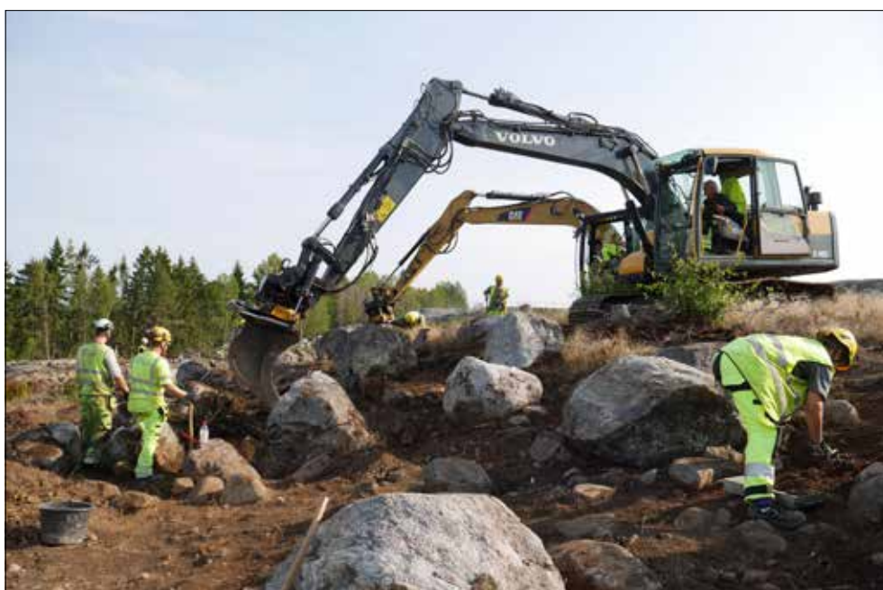
Figur 9. Den inledande ansiktningen av det övre vegetationsskiktet utfördes parallellt med två maskiner och var bitvis arbetskrävande i undersökningsområdets mer blockiga partier. Foto Jenny Holm från sydväst.
