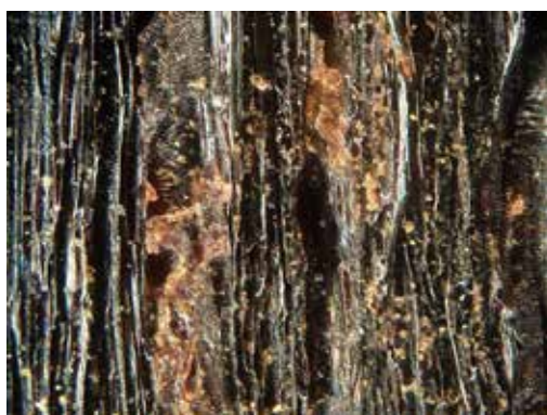
Stolphål A1225 Kraftig beläggning av silt. Den inre strukturen fylld med en bärnstensfärgad
