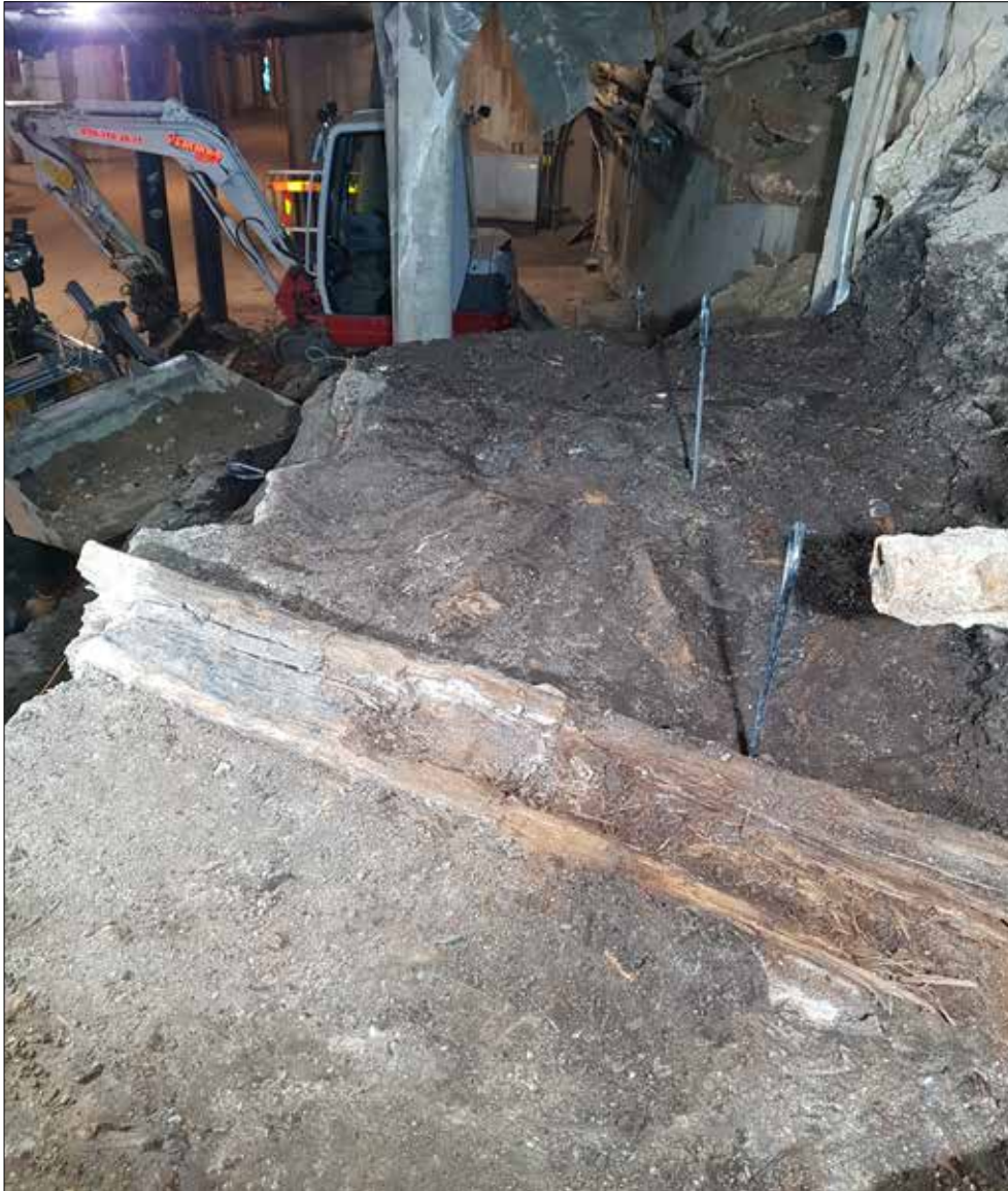
Figur 16. Syllstocken A2, i Hus 2, var kraftigt förrutnad och på golvnivån i huset fanns träflisor. I bakgrunden ses grävmaskinen, en frontlastare och körbanan i Citytunneln. Foto från norr.
