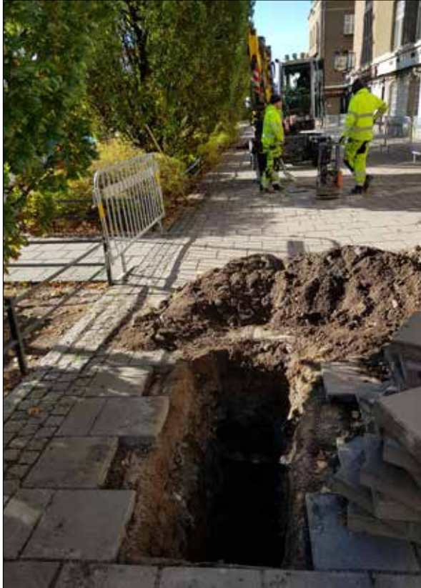
Figur 107. Översikt, schakt 39 som togs upp på trottoaren söder om Stadshotellet. Foto från nordöst.
