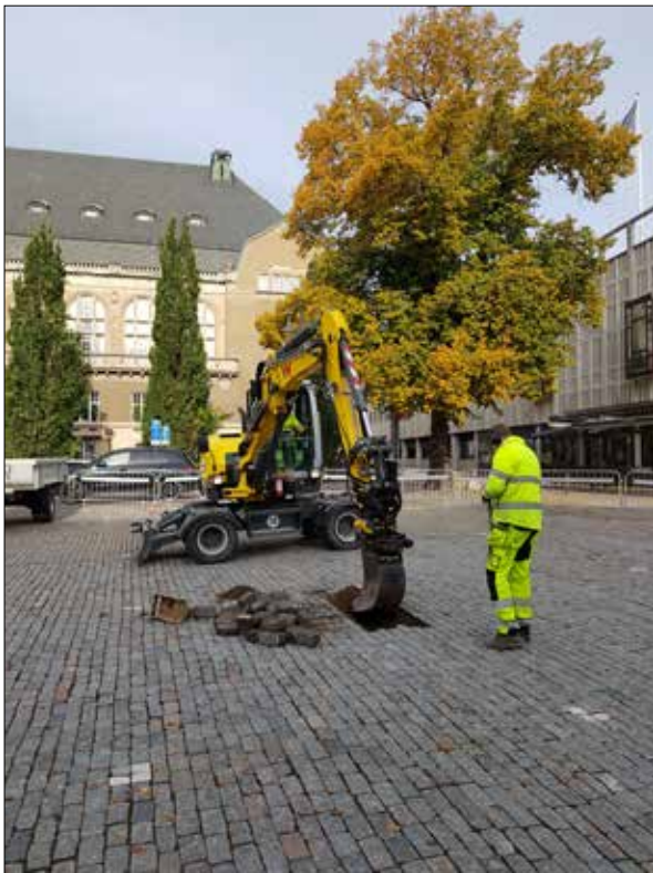
Figur 35. Schakt tas upp på Stora torget. Till höger skymtar Östra Kyrkogatan. I bakgrunden syns Stadshotellet. Foto från sydöst.
