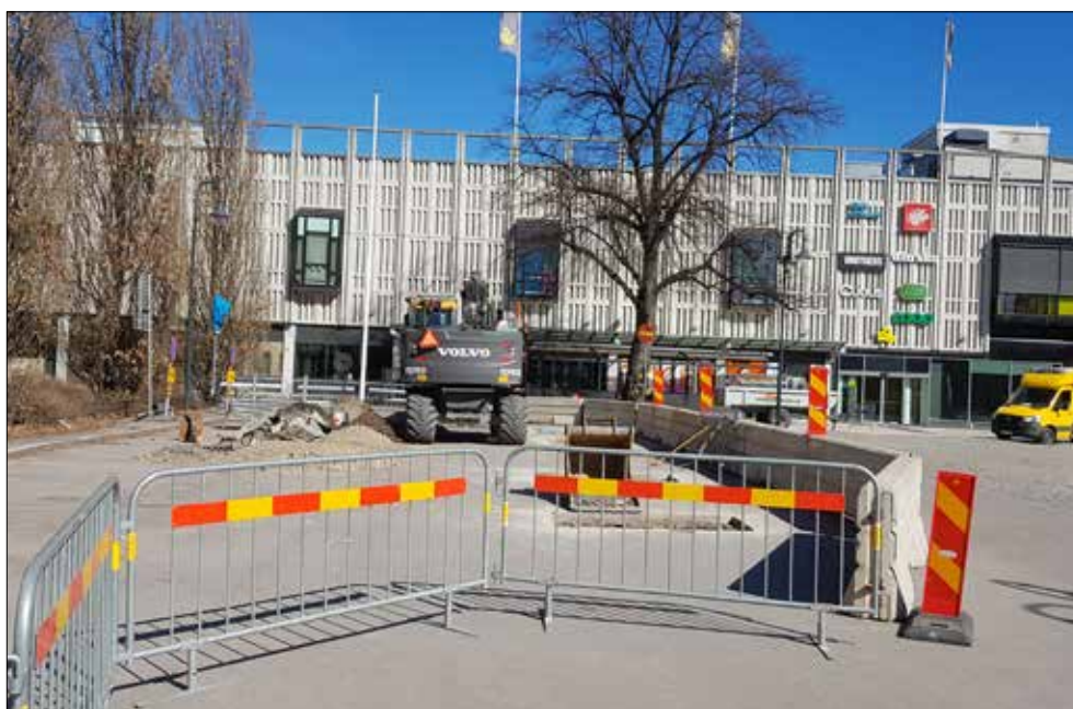
Figur 131. Översikt som visar området i gatan söder om Stadshotellet med schakt 45–49. Foto från öster.
