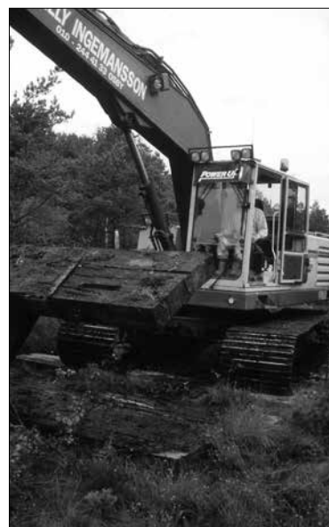
Figur 8.19. Vid sökschaktning i våtmarker inom E4-projektet norra Skåne användes stockmattor vid förhindra att grävmaskinen sjönk ner i det mjuka underlaget (Lagerås 2003:figur 6).
