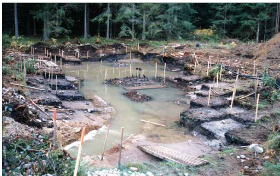
Figur 8.17. Kärret på Skogsmossen åter vattenfyllt efter en regnig helg när pumpen var avstängd. Foto: Fredrik Hallgren.
