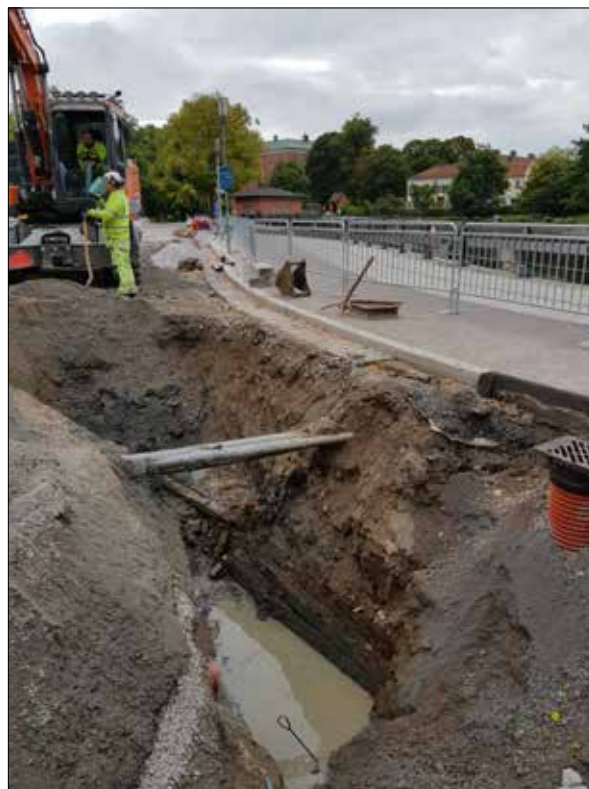
Figur 35. I schakt 2 framkom en spont, A3, som stadgat åkanten mot Svartån. Foto från norr.
