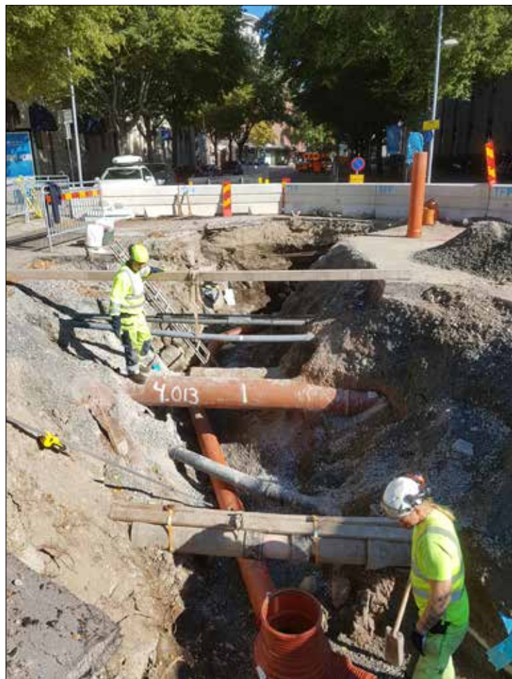
Figur 33. Arbetsbild som visar delar av schakt 1 (figur 18). I schaktet fanns många rör och ledningar. I schaktets bortre del fanns brofundamentet till Hospitalsbron, men det var avlägsnat då fotografiet togs. Foto från väster.
