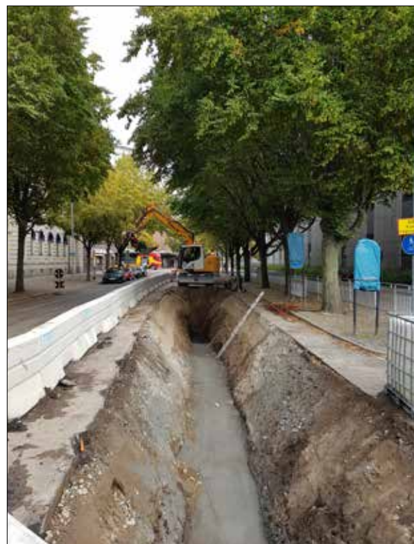
Figur 19. Schakt 1 i Munkgatan. I schaktets botten har en grusbädd för dagvattenledningen påförts. Lillåns södra stenskodda kajkant har legat till vänster på bilden, norr om schaktet. Foto från väster.
