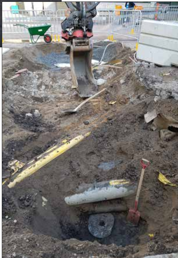
Figur 15. En medeltida handkvarn (F8) påträffades under fjärrvärmerören i schakt 1. Foto från väster.
