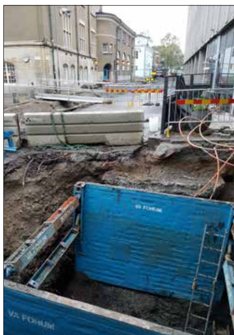
Figur 60. En schaktkassett lyftes ner i östra delen av schakt 5 för att förhindra att väggarna rasade. Foto från söder.
