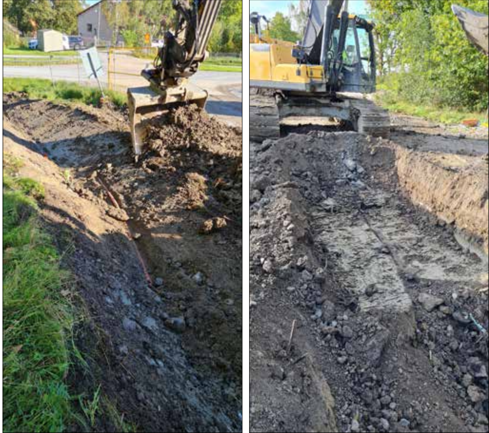
Figur 16 och 17. Schaktning för dike. T.v. norra delen av diket med Kvarnbergavägen i bakgrunden och påträffad gammal ledning, foto från söder. T.h. södra delen av diket med påträffad markduk centralt i diket, foto från norr.
