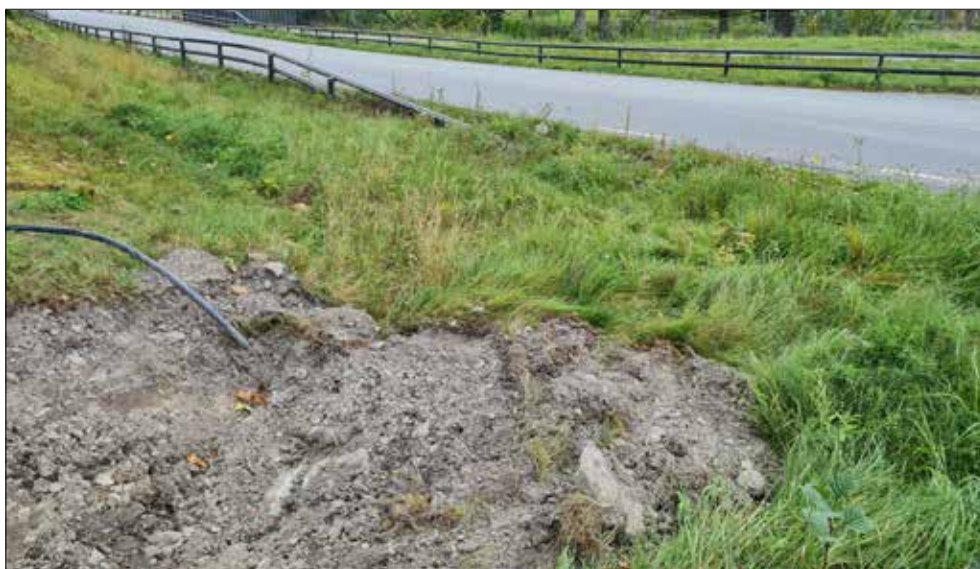
Figur 8. Slang tryckt under vägen i närheten av där schaktning för dagvattenutloppen skulle göras. Detta ingrepp gjordes dock inte av exploitören. Foto från söder.
